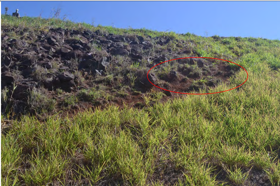
FOTO 59. REGIÃO DE TRANSIÇÃO ENTRE O ENROCAMENTO E A BARRAGEM DE TERRA COM INÍCIO DE RAVINAMENTO.
