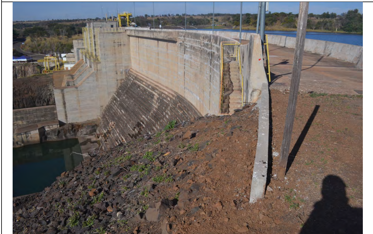
FOTO 39. JUSANTE DA BARRAGEM DE ENROCAMENTO. REGIÃO COM DESAGREGAÇÃO.
