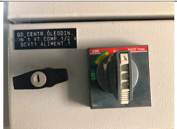
QDVT – Gaveta para alimentação AC 1 da central hidráulica 1 – Tag aparentemente errado
