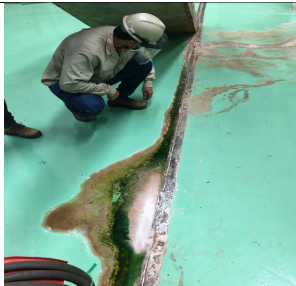
FOTO 18. JUNTA DE DILATAÇÃO ENTRE UG1 E UG2 – INFILTRAÇÃO NO PISO – NÃO APARENTA SINAIS DE COMPROMETIMENTO ESTRUTURAL, PORÉM O PISO DEVE SER SECADO COM PANO PARA EVITAR ÁGUA EM CONTATO COM AS PARTES METÁLICAS E EQUIPAMENTOS DA USINA.
