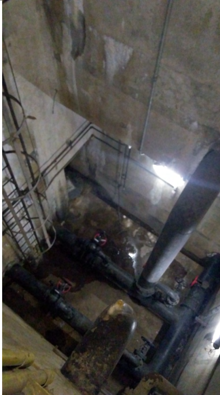
FOTO 77. ACESSO AO POÇO DE DRENAGEM. NO MOMENTO DA VISITA NÃO PÔDE SER ACESSADO.
