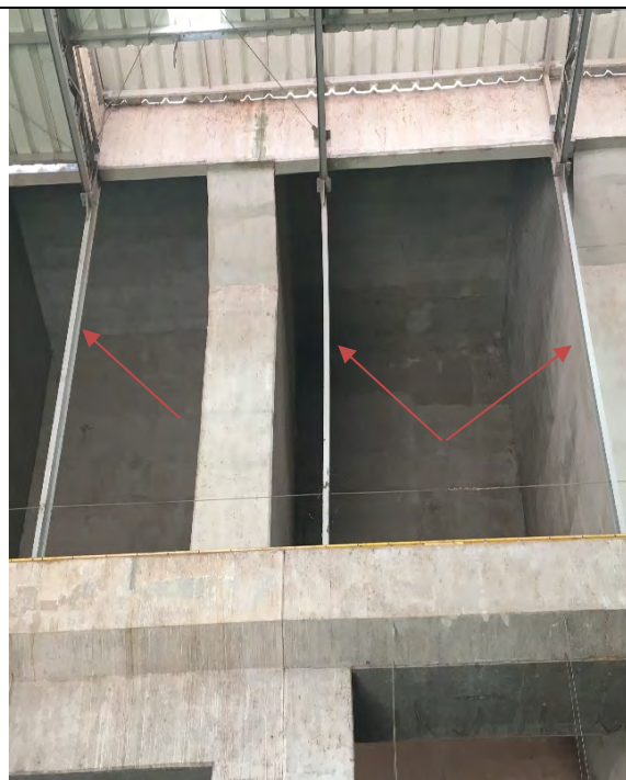
FOTO 5. PILARES METÁLICOS DE MONTANTE DA ESTRUTURA DA COBERTURA – SINAIS VISUAIS DE DEFORMAÇÃO LATERAL EXCESSIVA – RECOMENDO CONTRAVENTAR A MEIA ALTURA.
