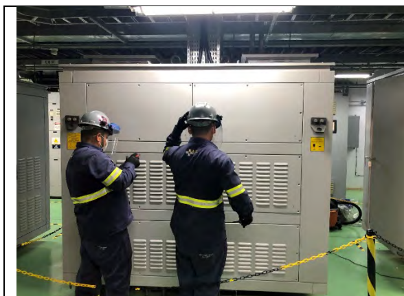
TSA1 – Transformador de Serviços Auxiliares 1 – Em manutenção periódica em conjunto com a manutenção periódica da UG1
