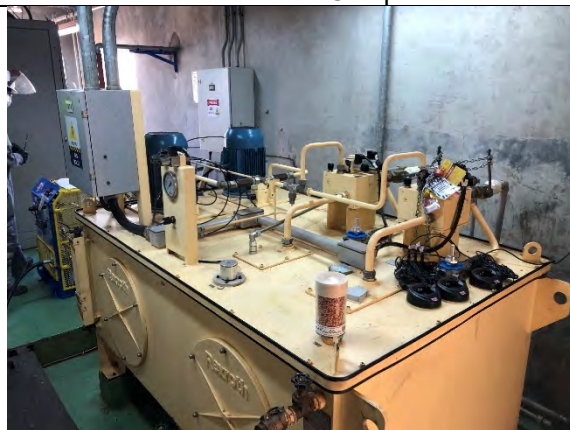
Unidade hidráulica 1 – Comportas 1 e 2
