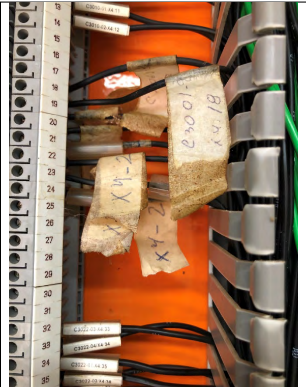
QSVT – Cabos sem anilhas com etiquetas temporárias – Aparentemente da época da construção
