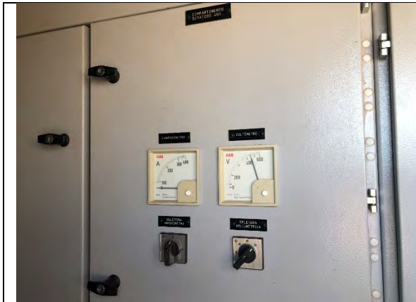
QDVT – Quadro de Distribuição de Corrente Alternada do Vertedouro
