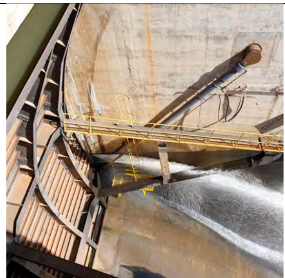
FOTO 48. VERTEDOIRO - BLOCO 1 – RECOMENDO AVALIAR NO ISR ELTROMECÂNICO A MANUTENÇÃO NA VEDAÇÃO DA COMPORTA. 1
