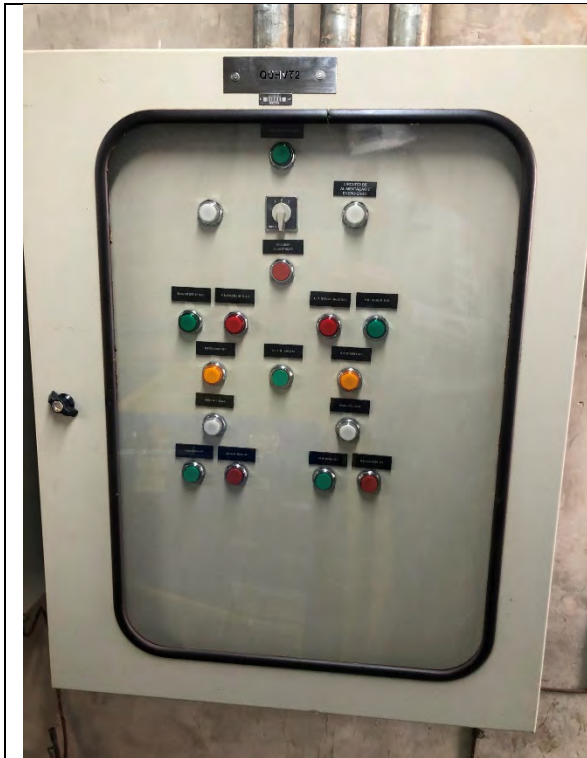
QUHV2 – Quadro de comando e controle da unidade hidráulica 2 – Comporta 3
