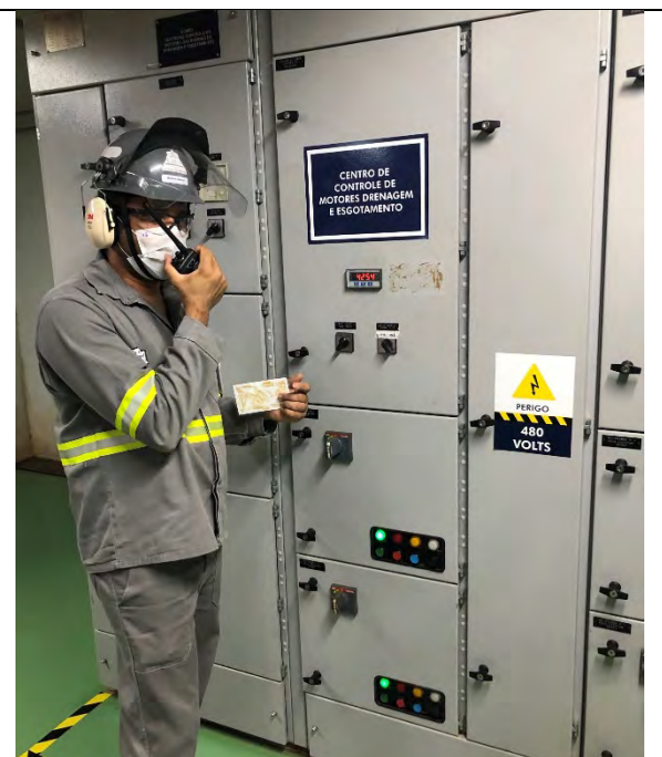
Autorizações em curso do operador local com a sala de controle para acionamento manual da motobomba de drenagem
