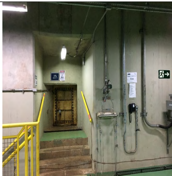
FOTO 29. GALERIA DE ACESSO ESCOTILHA DA CAIXA ESPIRAL DA UG1 - SEM SINAIS DE QUALQUER COMPROMETIMENTO ESTRUTURAL.
