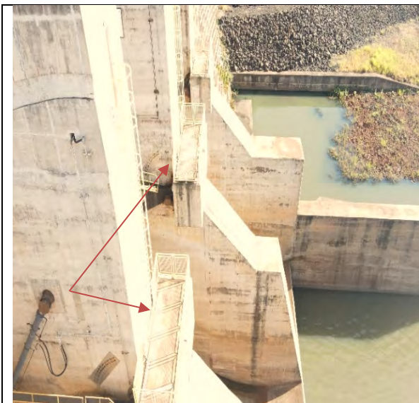
FOTO 45. VIGAS MUNHÃO – SEM SINAIS VISUAIS DE DESCOMPRESSÃO DA JUNTA PROTENDIDA DA VIGA COM O PILAR DO VT.
