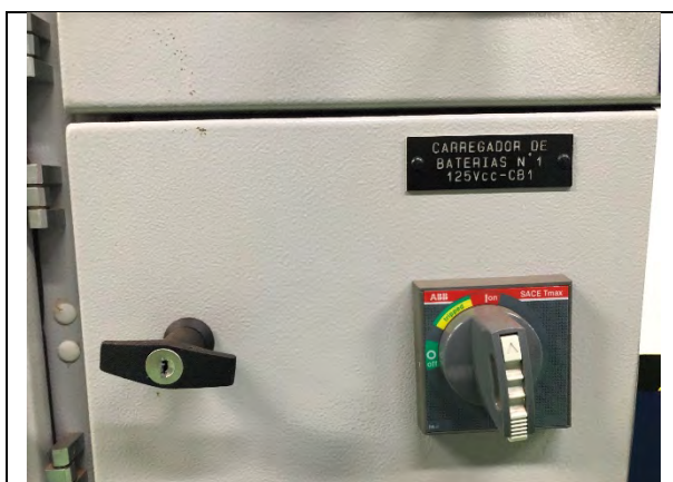
QPSA – Quadro Principal de Serviços Auxiliares – Gaveta para alimentação do Carregador de Baterias 1
