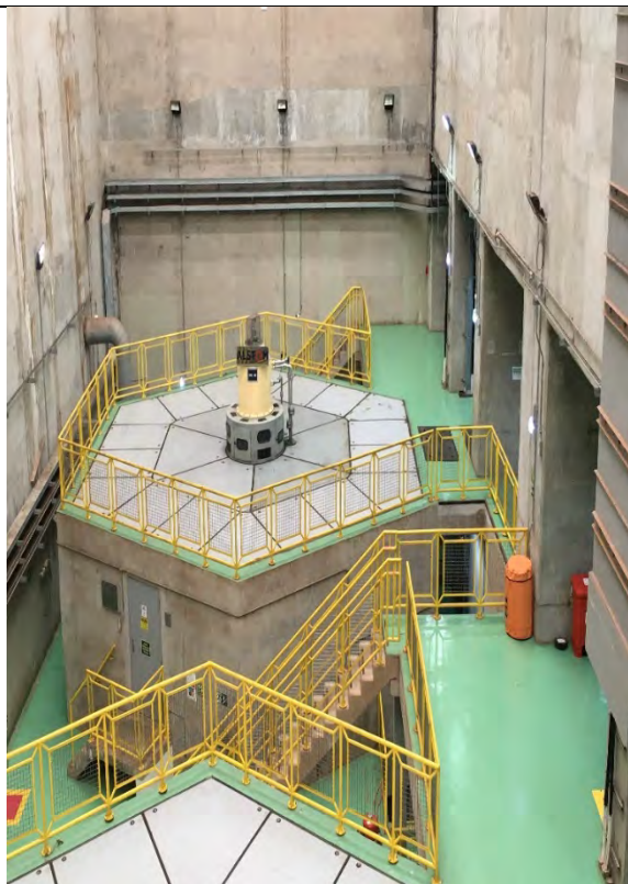
FOTO 12. BARRIL DO GERADOR – SEM SINAIS DE QUALQUER COMPROMETIMENTO ESTRUTURAL OU TÉRMICO.
