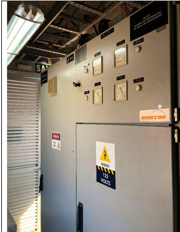
QCCVT – Quadro de Corrente Contínua do Vertedouro
