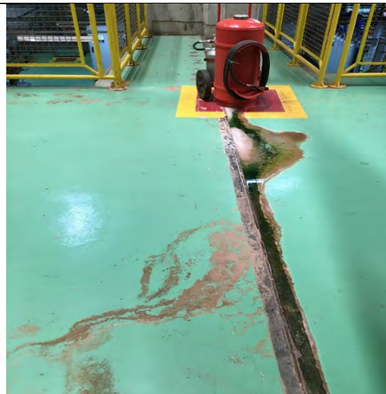
FOTO 19. JUNTA DE DILATAÇÃO ENTRE UG1 E UG2 – INFILTRAÇÃO NO PISO – NÃO APARENTA SINAIS DE COMPROMETIMENTO ESTRUTURAL, PORÉM O PISO DEVE SER SECADO COM PANO PARA EVITAR ÁGUA EM CONTATO COM AS PARTES METÁLICAS E EQUIPAMENTOS DA USINA.
