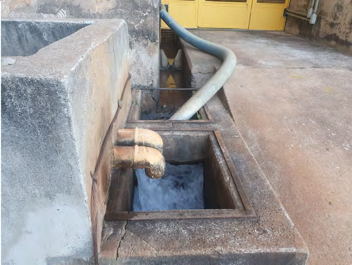
FOTO 33. DETALHE DA CAIXA COLETORA.
