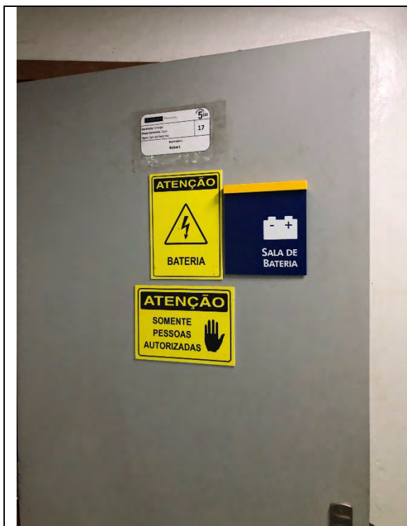
Acesso restrito a sala de baterias
