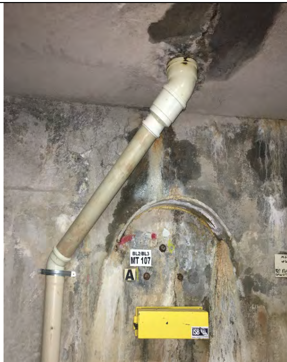
FOTO 61. JUNTA DE CONTRAÇÃO ENTRE OS BLOCOS 2 E 3 DA BARRAGEM-ME – INFILTRAÇÕES E CARBONATAÇÃO – SEM SINAIS MOVIMENTAÇÕES ANORMAIS – RECOMENDAÇÃO DE OBSERVAR O EVENTUAL AUMENTO DAS INFILTRAÇÕES.
