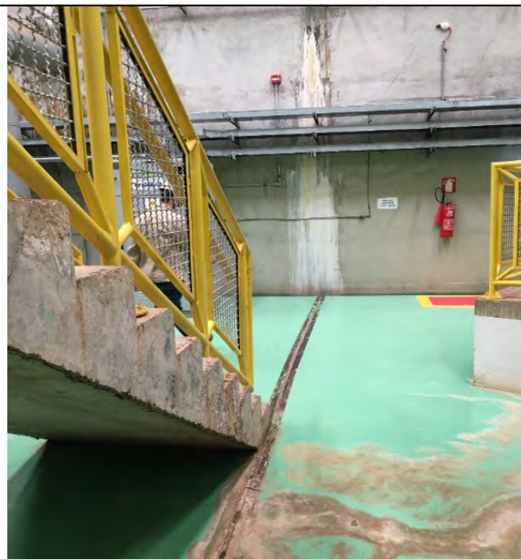
FOTO 17. JUNTA DE DILATAÇÃO ENTRE UG1 E UG2 – CARBONATAÇÃO E INFILTRAÇÃO NO PISO – NÃO APARENTA SINAIS DE COMPROMETIMENTO ESTRUTURAL, PORÉM O PISO DEVE SER SECADO COM PANO PARA EVITAR ÁGUA EM CONTATO COM AS PARTES METÁLICAS E EQUIPAMENTOS DA USINA.
