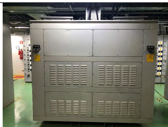
TSA2 – Transformador de Serviços Auxiliares 2
