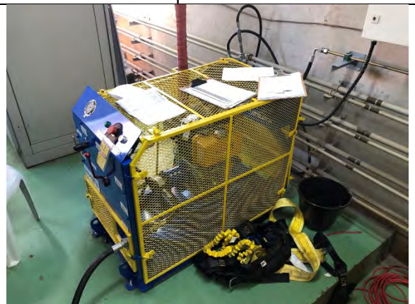
Unidade hidráulica autônoma para uso em emergência no acionamento das comportas 1 e 2 (em testes)
