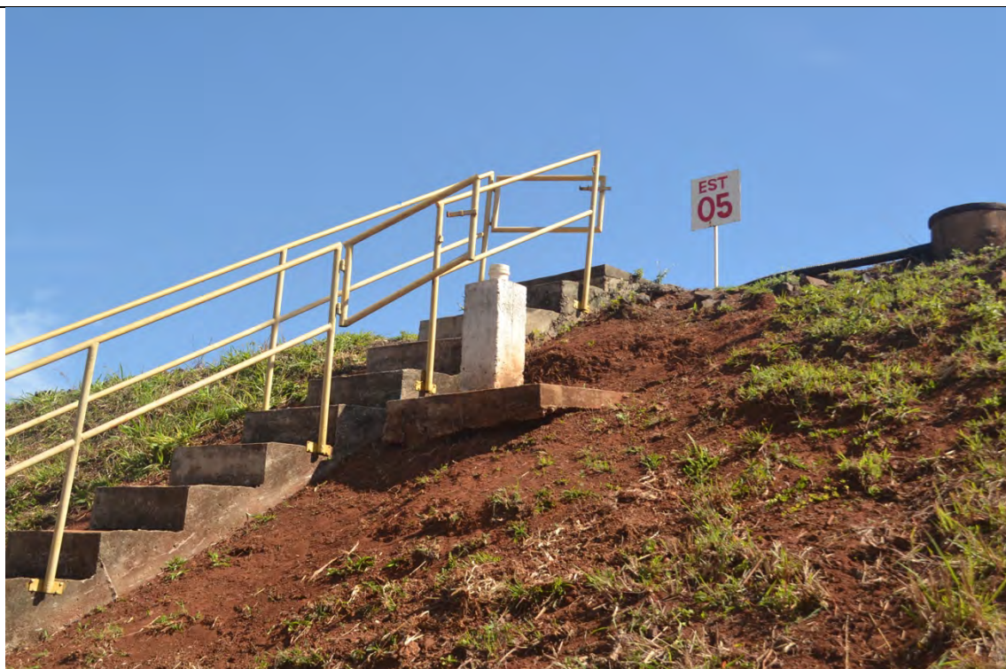
FOTO 11. EROSÃO NA BASE DO PIEZÔMETRO PZ-06.
