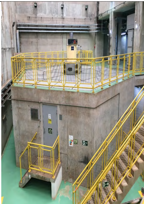
FOTO 13. BARRIL DO GERADOR – SEM SINAIS DE QUALQUER COMPROMETIMENTO ESTRUTURAL OU TÉRMICO.
