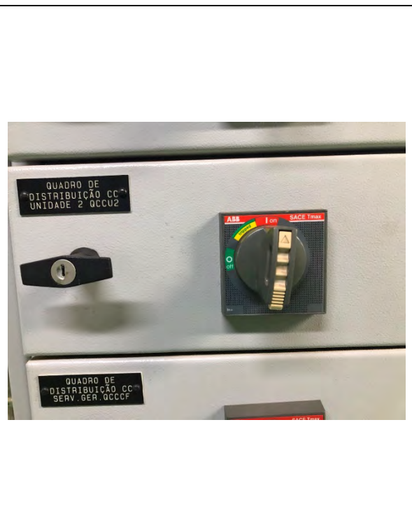
QCCG2 – Quadro principal 2 de corrente contínua – Gaveta para alimentação 2 do QCCCF
