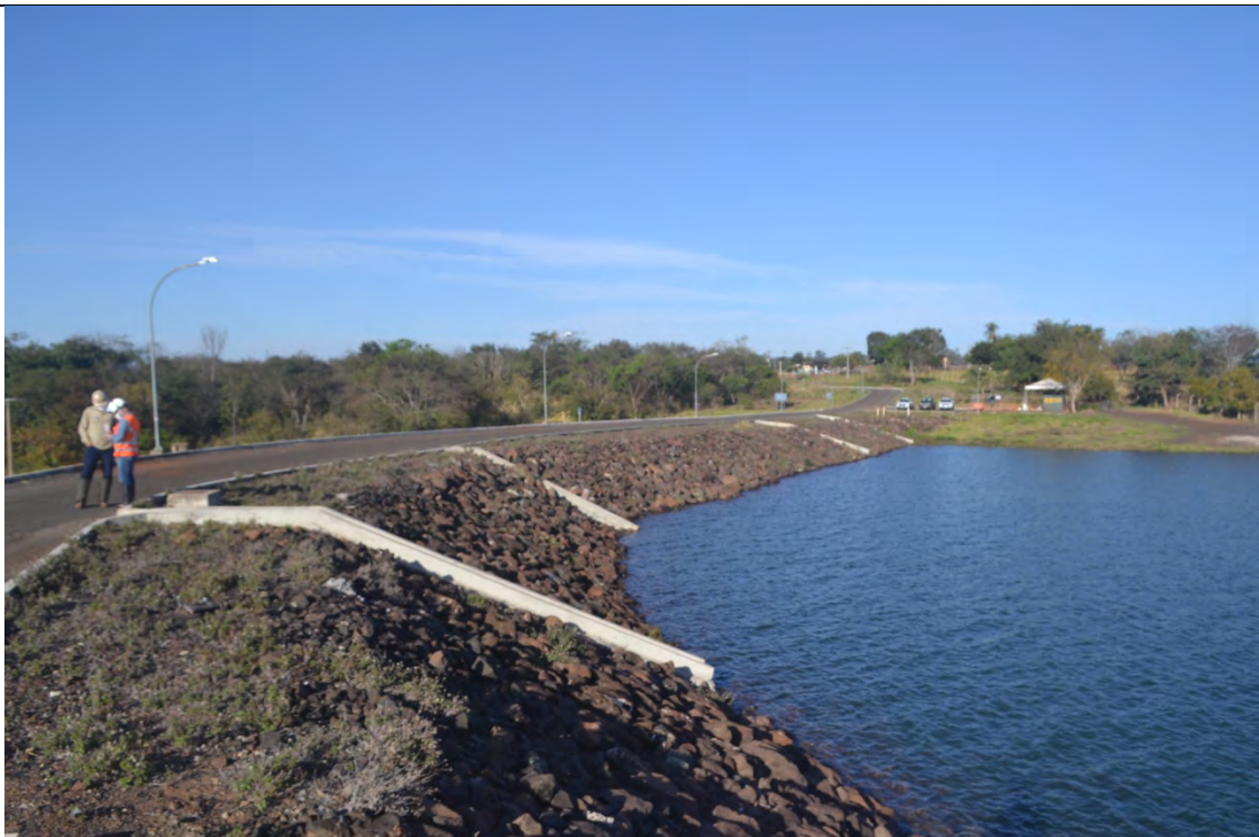
FOTO 3. CRISTA E ENROCAMENTO NA MARGEM DIREITA, FACE MONTANTE. OBSERVA-SE AS CANALETAS RECÉM CONSTRUIDAS.
