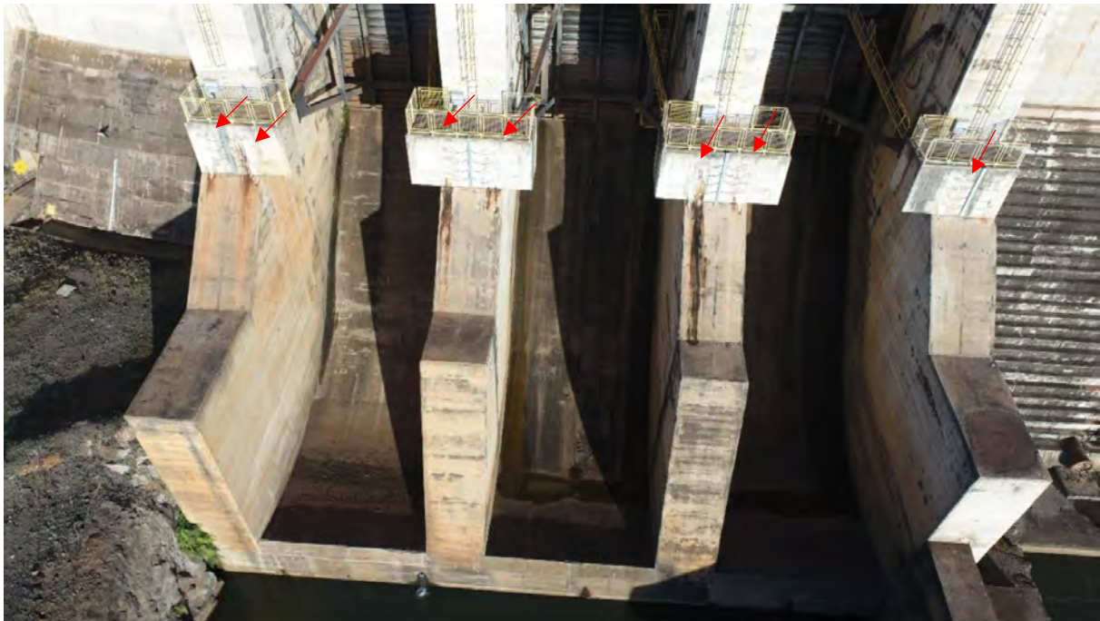
FOTO 1. VIGAS MUNHÃO DA UHE CAÇU, COM INDICAÇÃO DE SINAIS DE INFILTRAÇÃO ATRAVÉS DAS BAINHAS.
