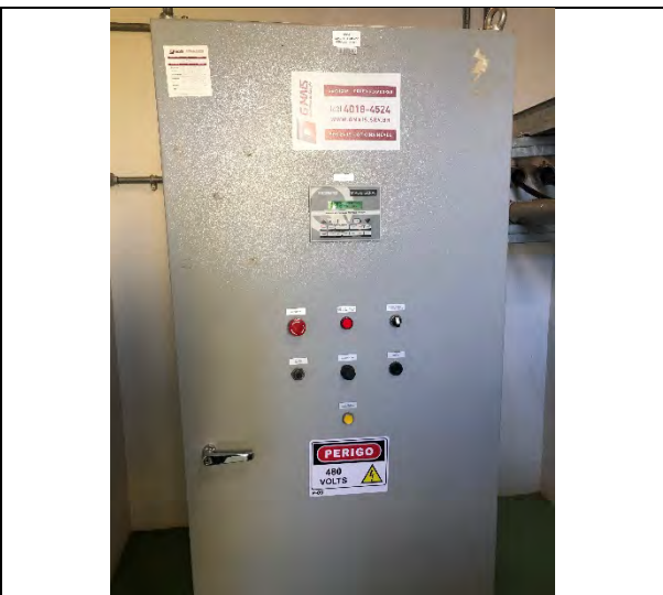
Quadro de Controle do Gerador Diesel de Emergência
