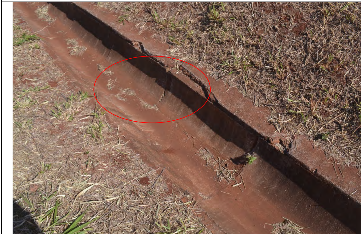
FOTO 57. TRINCAS NA CANALETA.
