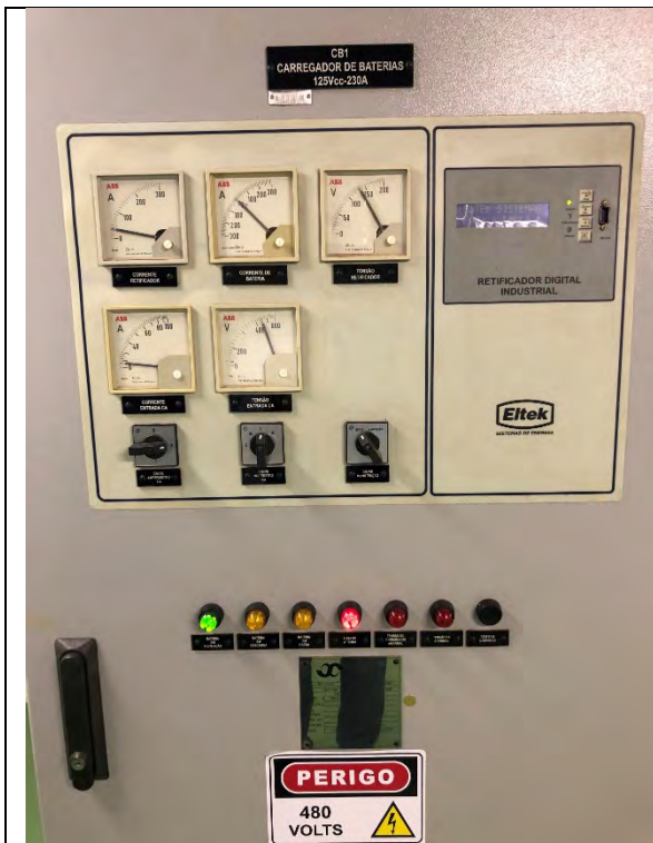
Carregador de Baterias 1 – Alarme de fuga a terra
