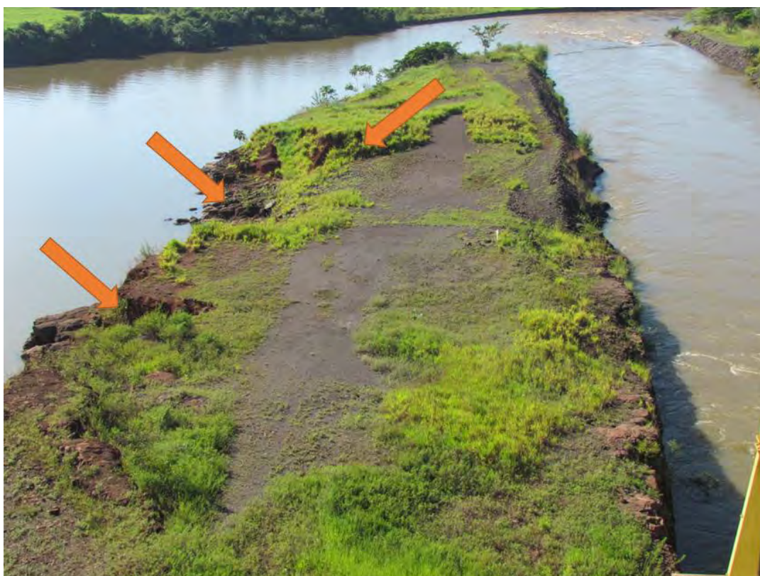
Figura 2. Indicação de erosões no Septo. Fonte: Fractal Engenharia e Sistemas.
