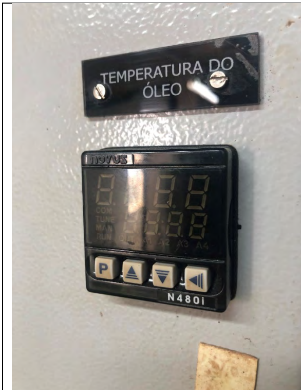
Indicador local da temperatura do óleo da central hidráulica – fora de operação
