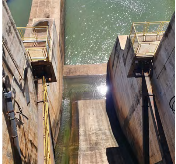
FOTO 50. DESGASTE NO CONCRETO DA SOLEIRA VERTENTE – BLOCO 3 – VISUALMENTE NÃO APARETA NECESSITAR REPAROS. 2
