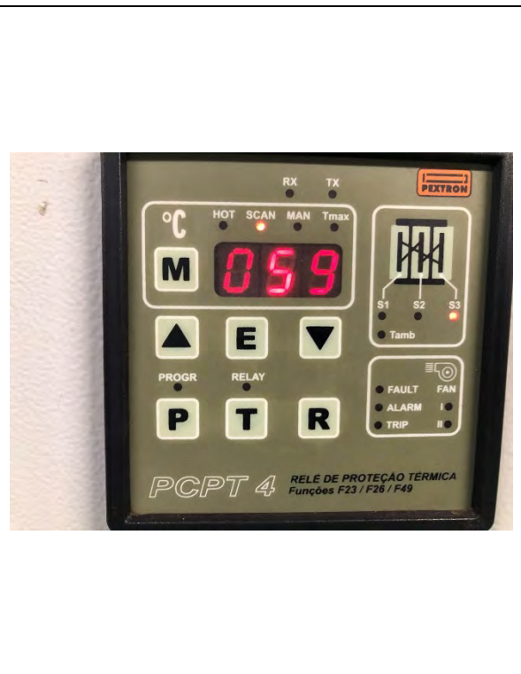
TSA2 – Transformador de Serviços Auxiliares 2 – Em operação – Temperatura Fase C
