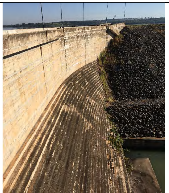
FOTO 55. VISTA DE JUSANTE DA BARRAGEM EM CCR E DO MURO DE TRANSIÇÃO-ME COM A BARRAGEM DE TERRA – SEM SINAIS DE COMPROMETIMENTO ESTRUTURAL.
