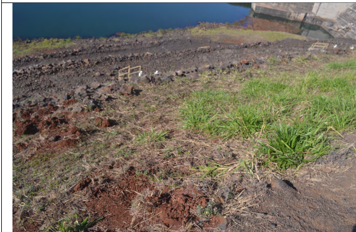
FOTO 41. SULCO EROSIVO EM REGIÃO COM SOLO, PRÓXIMO A CRISTA.
