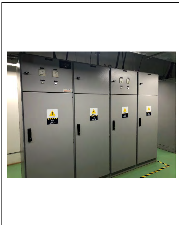
QCCCF – Quadro de Distribuição de 125 VCC das Cargas Gerais
