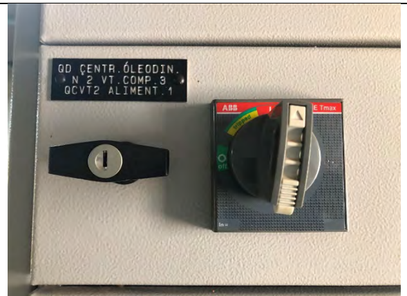
QDVT – Gaveta para alimentação AC 1 da central hidráulica 2 – Tag aparentemente errado
