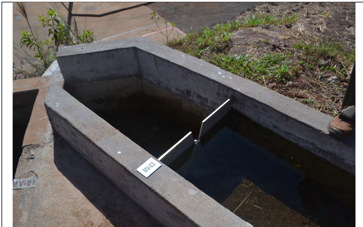
FOTO 17. MEDIDOR DE VAZÃO MV-03 EM BOM ESTADO.
