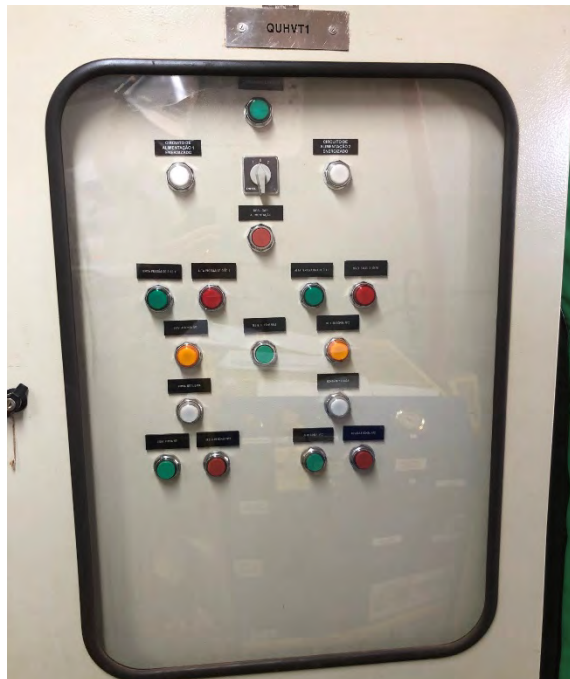
QUHV1 – Quadro de comando e controle da unidade hidráulica 1 – Comportas 1 e 2
