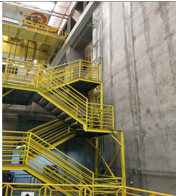
FOTO 10. JUNTA DE CONTRAÇÃO ENTRE AM E CF – RECOMENDO MONITORAR. SUPERFÍCIE DEVE SER SECADA COM PANO PARA EVITAR ÁGUA ESCORRENDO PELA CF E EM CONTATO COM AS PARTES METÁLICAS E EQUIPAMENTOS DA USINA.
