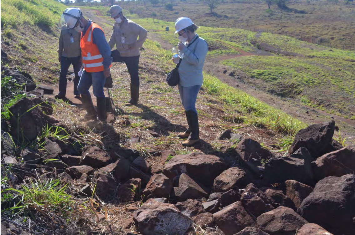
FOTO 60. REGIÃO COM PASSAGEM DE ÁGUA ABAIXO DO ENROCAMENTO.
