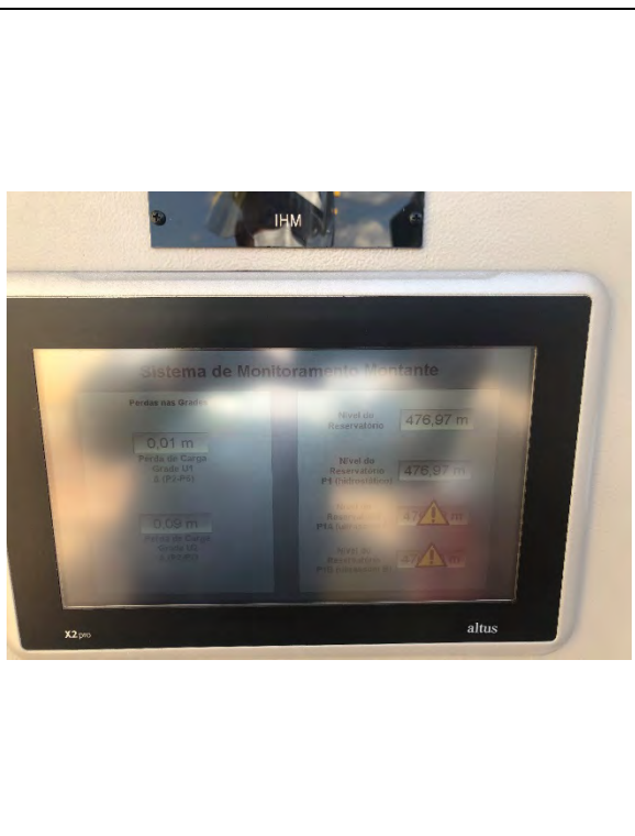
Sistema de Medições Hidráulicas – IHM local na barragem
