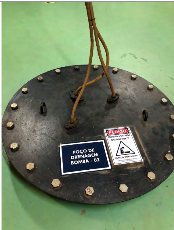
Tampa do poço de drenagem – passagem do cabeamento da motobomba 2
