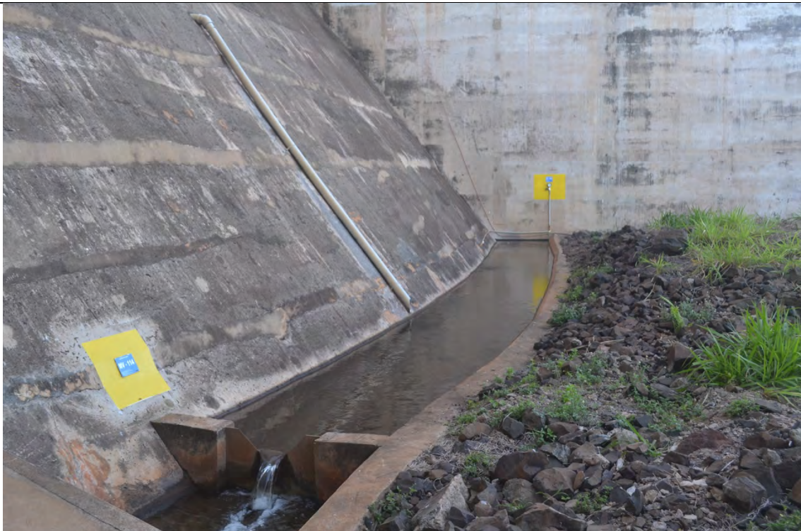
FOTO 32. MEDIDOR TRIANGULAR DE VAZÃO MV-114.
