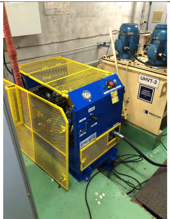
Unidade hidráulica autônoma para uso em emergência no acionamento da comporta 3 (em testes)
