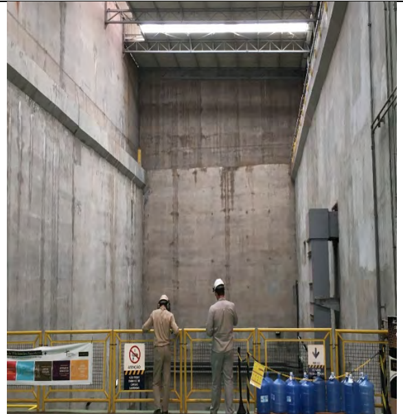
FOTO 7. PAREDES DA CASA DE FORÇA – ALGUMAS POUÇAS INFILTRAÇÕES DE PEQUENA MAGNITUDE A MONTANTE – SEM COMPROMETIMENTO ESTRUTURAL VISÍVEL.
