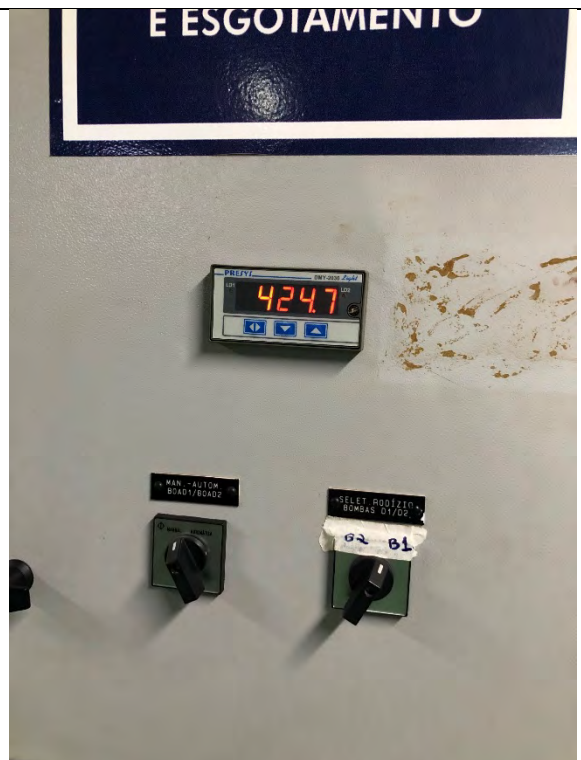
Nível do poço de drenagem reduzindo na operação manual da motobomba
