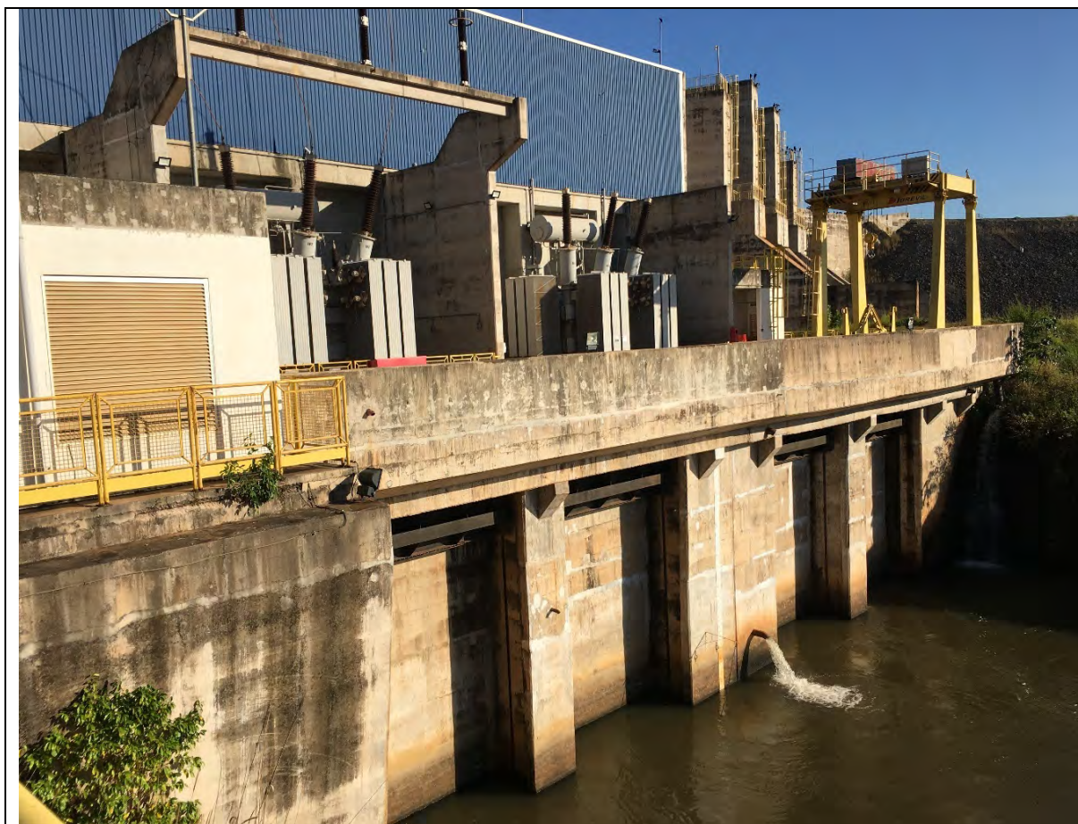
FOTO 1. CASA DE FORÇA – VISTA GERAL – PAREDES DO CONTRAFORTE DE JUSANTE, PÁTIO DOS TRANSFORMADORES, PAREDES CORTA-FOGO E ESTRUTURA DE SAÍDA DE LINHA SEM SINAIS DE QUALQUER COMPROMETIMENTO ESTRUTURAL.
