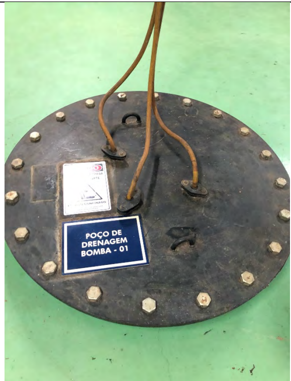
Tampa do poço de drenagem – passagem do cabeamento da motobomba 1
