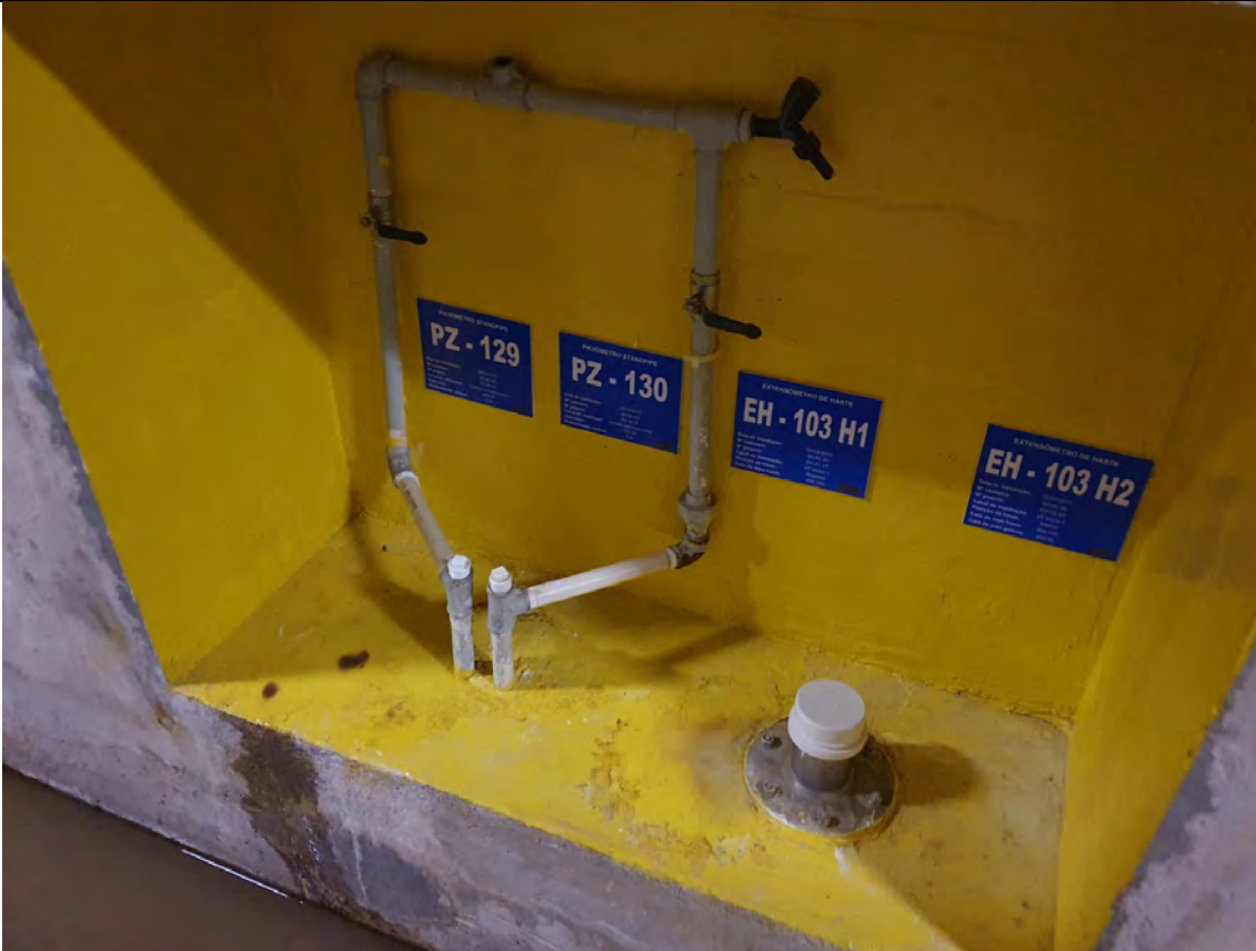
FOTO 34. INSTRUMENTAÇÃO COM PIEZÔMETROS E EXTENSÔMETROS DE HASTE.
