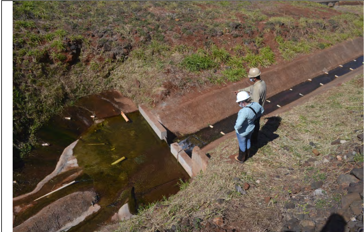
FOTO 62. REGIÃO DO MEDIDOR DE VAZÃO.
