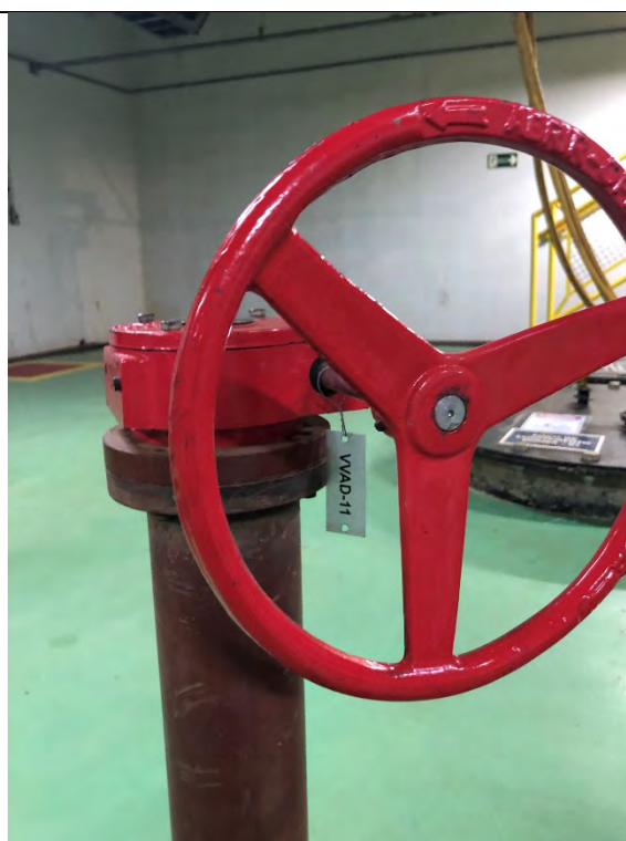
Válvula de interligação dos poços de drenagem e esgotamento – Identificação (tags) presente
