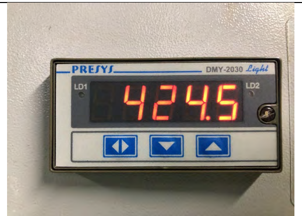
Medição local (CCMDE) do nível do poço de drenagem
