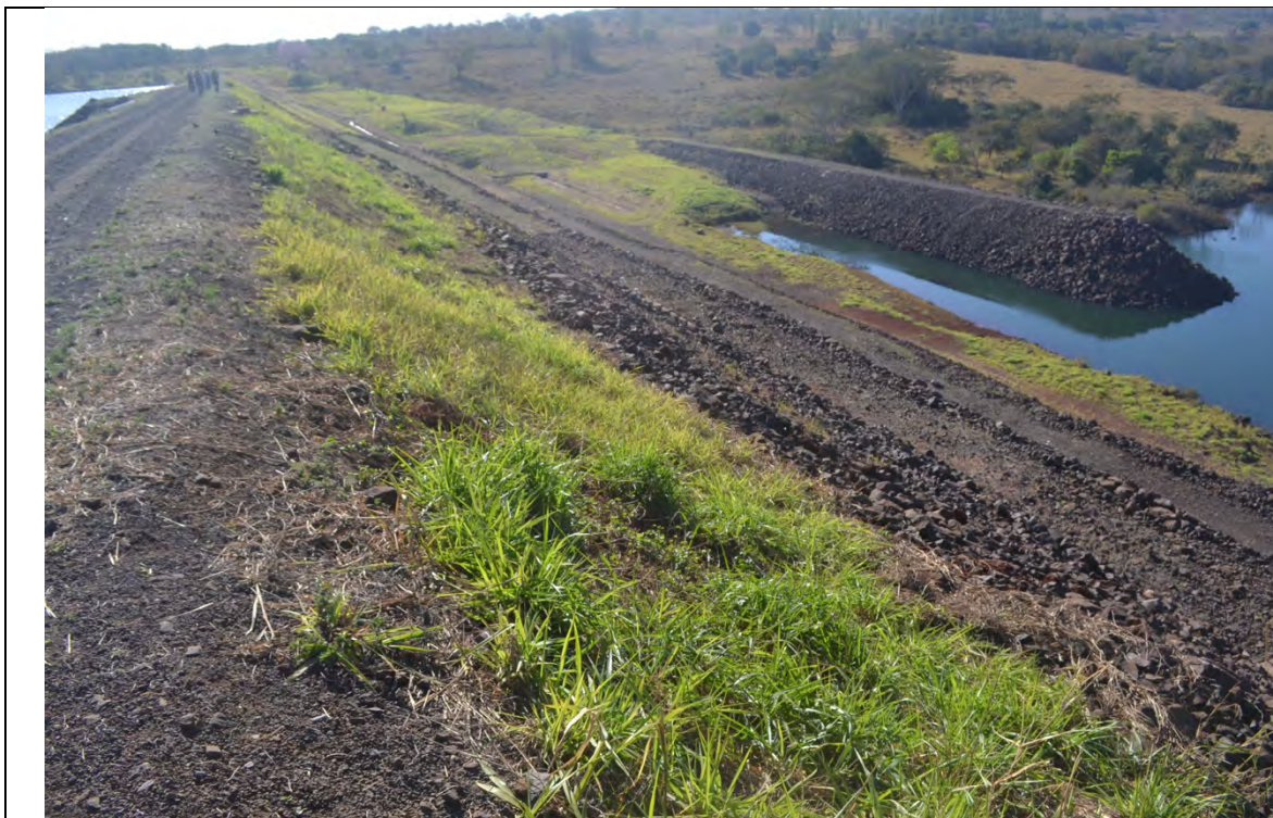
FOTO 40. REGIÃO COM DEPRESSÕES PRÓXIMO À CRISTA DA BARRAGEM DE ENROCAMENTO, FACE JUSANTE.
