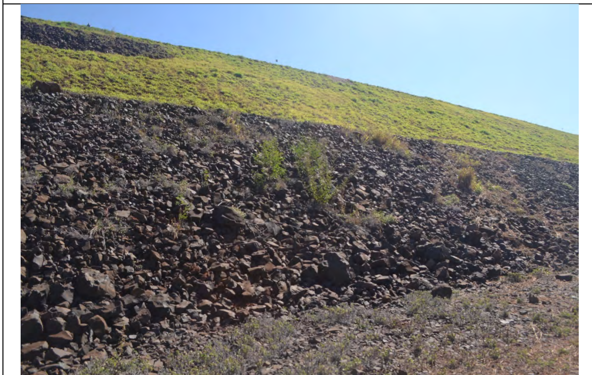
FOTO 65. ARBUSTOS EM MEIO AO ENROCAMENTO.
