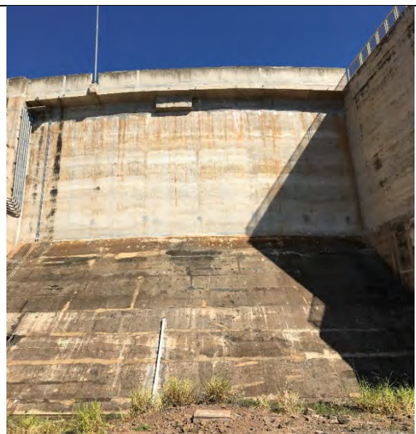
FOTO 44. VISTA DE JUSANTE DA BARRAGEM DE LIGAÇÃO - SEM SINAIS DE QUALQUER COMPROMETIMENTO ESTRUTURAL.
