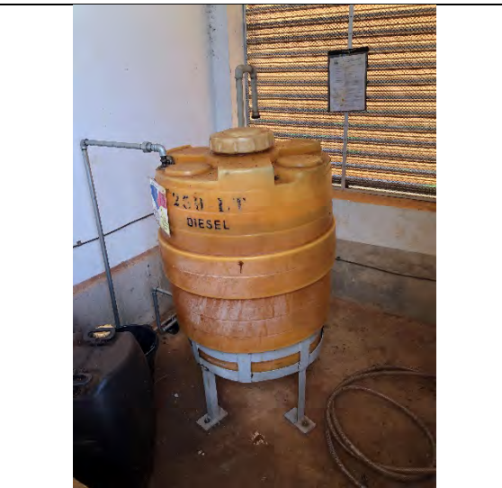
Reservatório de Óleo Diesel do Gerador Diesel de Emergência
