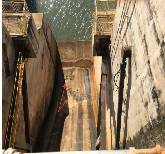
FOTO 49. DESGASTE NO CONCRETO DA SOLEIRA VERTENTE – BLOCO 2 – RECOMENDO REPAROS NO CONCRETO.
