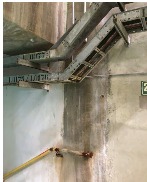
FOTO 20. JUNTA DE CONTRAÇÃO ENTRE AM E UG1 NA DESCIDA PARA A GALERIA MECÂNICA – NÃO APARENTA SINAIS DE COMPROMETIMENTO ESTRUTURAL, PORÉM SUPERFÍCIE DEVE SER SECADA COM PANO PARA EVITAR ÁGUA ESCORRENDO PELA CF E EM CONTATO COM AS PARTES METÁLICAS E EQUIPAMENTOS DA USINA.
