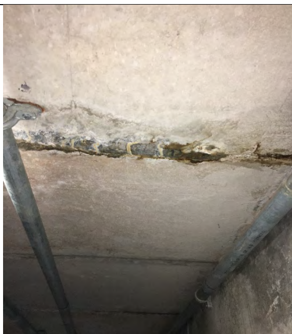
FOTO 62. JUNTA DE CONTRAÇÃO NO TETO ENTRE OS BLOCOS 2 E 3 DA BARRAGEM-ME – INFILTRAÇÕES E CARBONATAÇÃO – SEM SINAIS MOVIMENTAÇÕES ANORMAIS – RECOMENDAÇÃO DE OBSERVAR O EVENTUAL AUMENTO DAS INFILTRAÇÕES.
