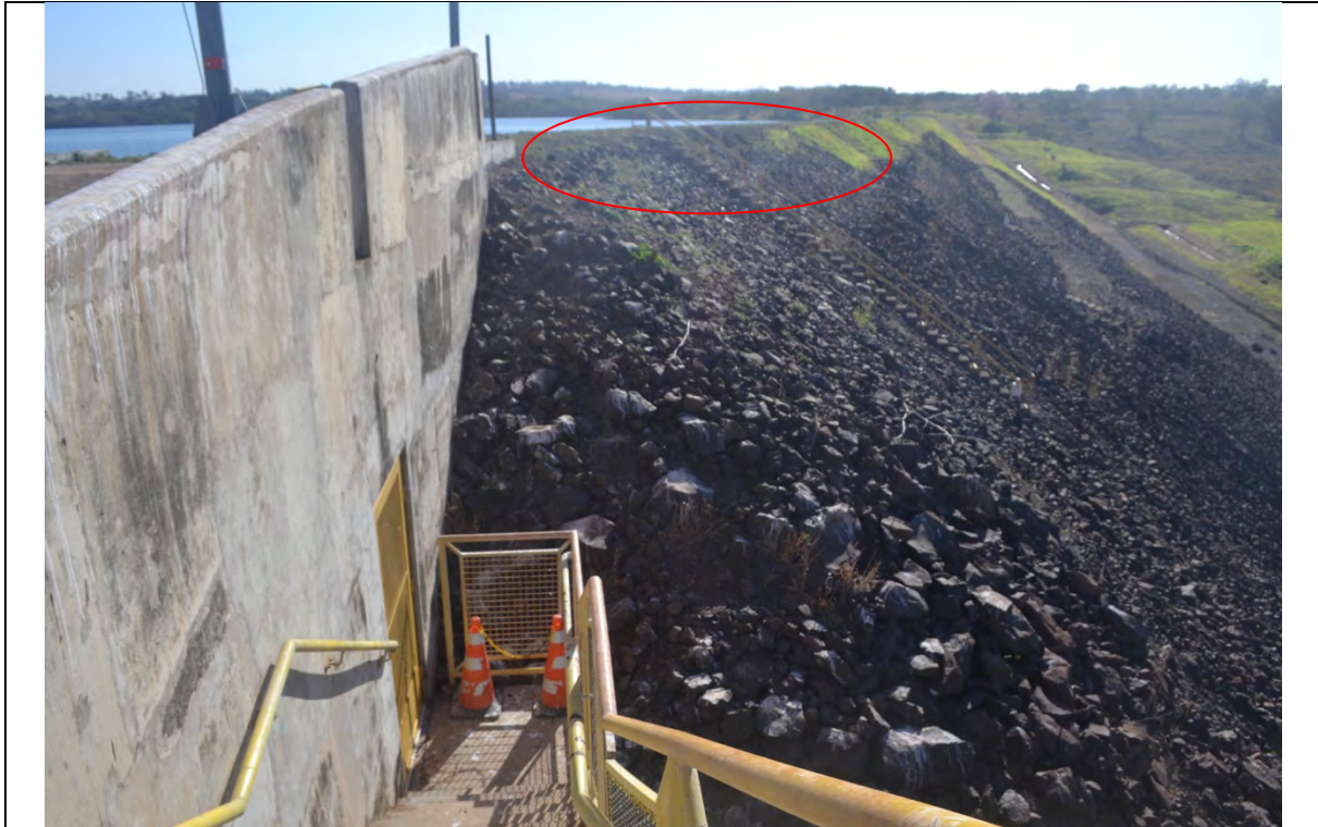
FOTO 38. REGIÃO DA TRANSIÇÃO ENTRE O ENROCAMENTO E A BARRAGEM DE CCR. NO DESTAQUE REGIÃO COM PERDA DE MATERIAL GRANULAR.
