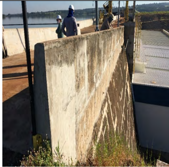
FOTO 34. BARRAGEM TRANSIÇÃO NA MD – VISTA DE JUSANTE - SEM SINAIS DE QUALQUER COMPROMETIMENTO ESTRUTURAL.
