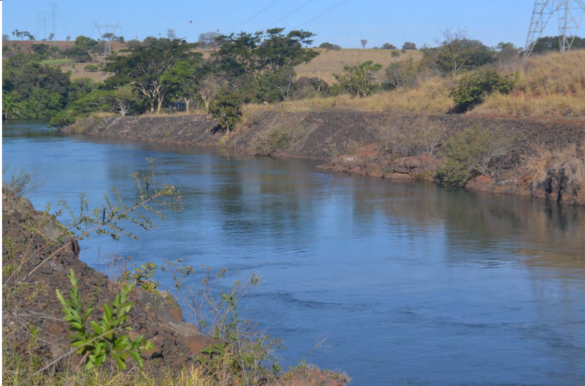
FOTO 20. MARGEM DIREITA DO CANAL DE RESTITUIÇÃO. VEGETAÇÃO ARBOREA DEVE SER REMOVIDA.
