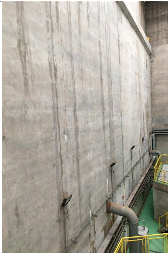
FOTO 8. PAREDES DE MONTANTE DA CASA DE FORÇA (UG1 E UG2) – ALGUMAS POUÇAS INFILTRAÇÕES DE PEQUENA MAGNITUDE – SEM COMPROMETIMENTO ESTRUTURAL VISÍVEL.
