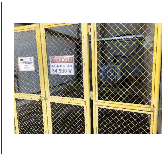
TSA3 – Transformador de Serviços Auxiliares (a óleo) – Localizado na área externa
