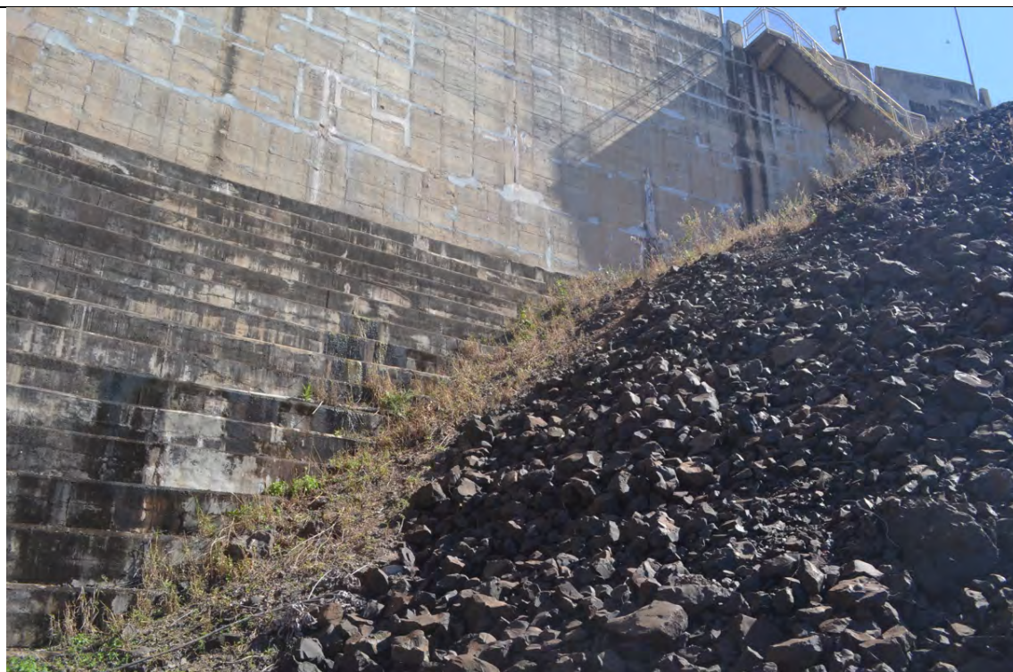
FOTO 47. DETALHE DA REGIÃO DE TRANSIÇÃO ENTRE A BARRAGEM CCR E O ENROCAMENTO, COM SINAIS DE ESCOAMENTO DE ÁGUAS PLUVIAIS E DESAGREGAÇÃO DO ENROCAMENTO.
