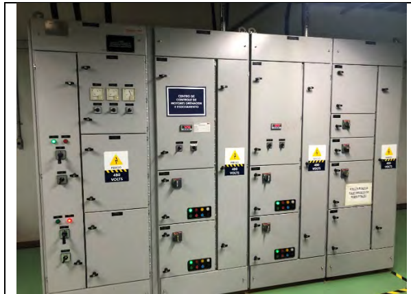
CCMDE – Quadro de Comando dos Motores da Drenagem e Esgotamento (CCMDE)
