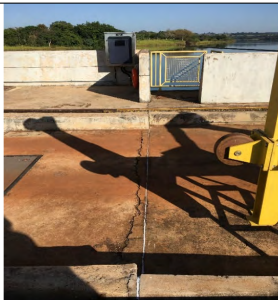
FOTO 37. JUNTA DE CONTRAÇÃO ENTE A BARRAGEM-MD E A TOMADA D'ÁGUA - SEM SINAIS MOVIMENTAÇÕES ANORMAIS – TRINCA DE RETRAÇÃO NA ARGAMASSA DE ACABAMENTO – SEM NECESSIDADE DE QUALQUER REPARO POIS NÃO É ESTRUTURAL.
