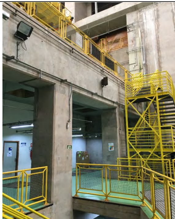
FOTO 15. ESTRUTURA DE SUPORTE DO PISO DA ÁREA DE MONTAGEM – SEM COMPROMETIMENTO ESTRUTURAL VISÍVEL.
