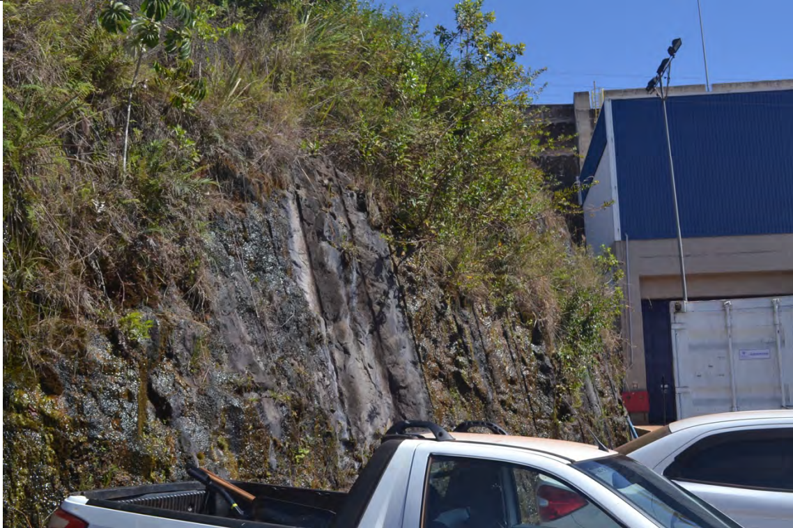
FOTO 69. VEGETAÇÃO NA CRISTA DO TALUDE.
