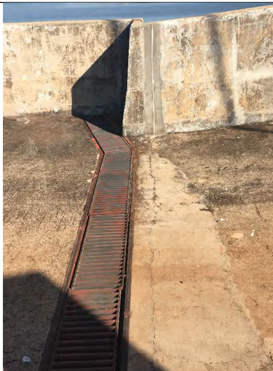
FOTO 57. JUNTA DE CONTRAÇÃO ENTRE A BARRAGEM-ME E O MURO DE TRANSIÇÃO – SEM SINAIS MOVIMENTAÇÕES ANORMAIS – TRINCA NA ARGAMASSA DE ACABAMENTO – NÃO É NECESSÁRIO REPARO ALGUM, POIS NÃO É ESTRUTURAL.
