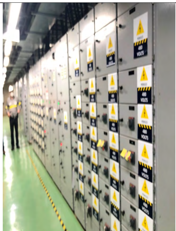
QPSA – Quadro Principal de Serviços Auxiliares
