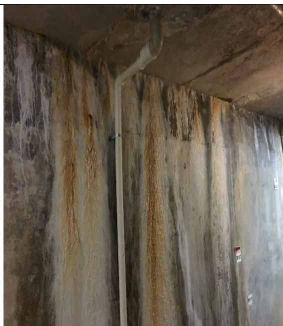
FOTO 63. JUNTA DE CONTRAÇÃO ENTRE OS BLOCOS 2 E 3 DA BARRAGEM-ME – INFILTRAÇÕES E CARBONATAÇÃO – SEM SINAIS MOVIMENTAÇÕES ANORMAIS – RECOMENDAÇÃO DE OBSERVAR O EVENTUAL AUMENTO DAS INFILTRAÇÕES.
