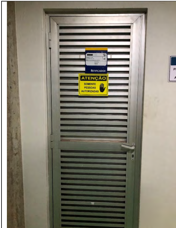
Acesso restrito a sala de retificadores
