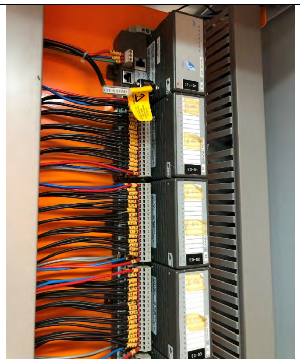
QSVT – Quadro de Supervisão e Controle do Vertedouro – Unidade remota de aquisição de dados
