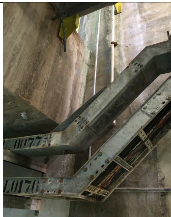
FOTO 21. JUNTA DE CONTRAÇÃO ENTRE AM E UG1 NA DESCIDA PARA A GALERIA MECÂNICA – NÃO APARENTA SINAIS DE COMPROMETIMENTO ESTRUTURAL, PORÉM SUPERFÍCIE DEVE SER SECADA COM PANO PARA EVITAR ÁGUA ESCORRENDO PELA CF E EM CONTATO COM AS PARTES METÁLICAS E EQUIPAMENTOS DA USINA.
