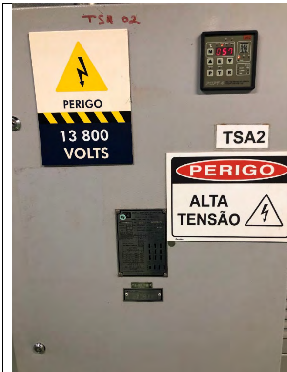
TSA2 – Transformador de Serviços Auxiliares 2 – Em operação
