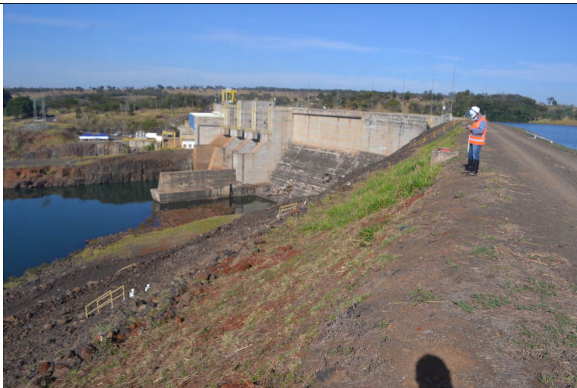
FOTO 42. VISTA DA REGIÃO COM DEPRESSÕES (FORMADAS PELA DESAGREGAÇÃO DO MATERIAL) E SULCOS EROSIVOS.
