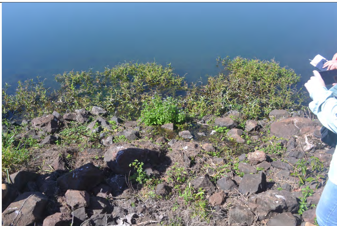
FOTO 67. REGIÃO COM SURGÊNCIA DE ÁGUA. NÃO SE OBSERVA CARREAMENTO DE MATERIAL.
