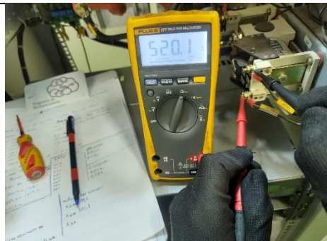
Figura 08: Realização de medições de grandezas elétricas.
