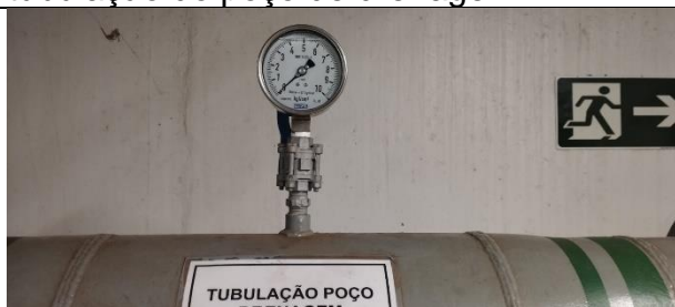
Figura 66: Verificação do estado de conservação dos manômetros da tubulação do poço de drenagem.
