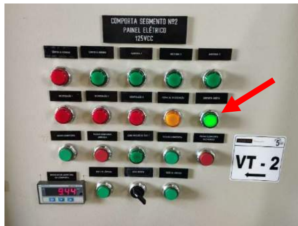
Figura 69 – Sinalização de COMPORTA ABERTA VT - 2
