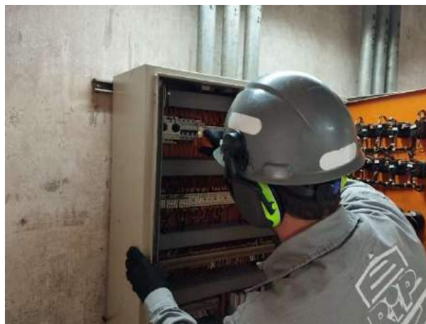
Figura 118 – Inspeção e testes nos componentes internos dos quadros VT - 3
