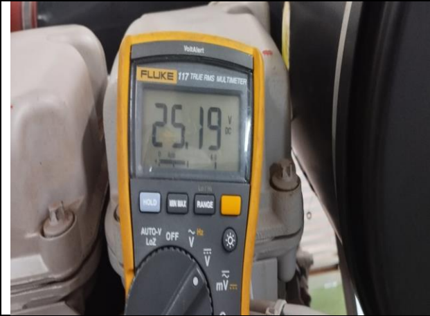
Figura 19 - Medição de grandeza da bateria 25,19Vcc
