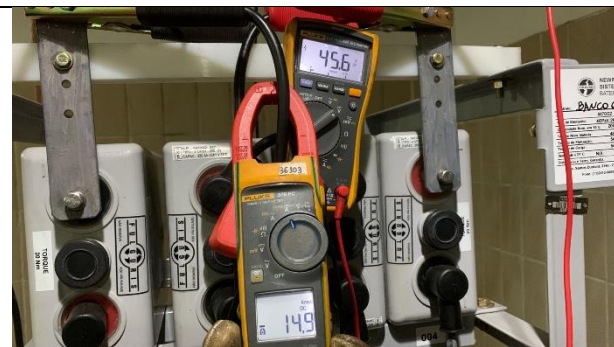
Figura 07 – Medições de tensão do conjunto do banco de baterias.
