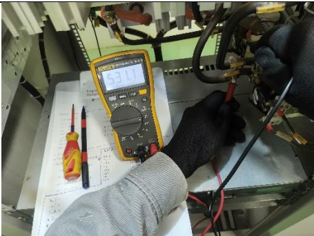
Figura 05: Realização de medições de grandezas elétricas.
