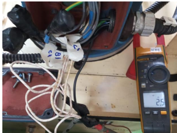
Verificações na resistência de aquecimento do motor 2
