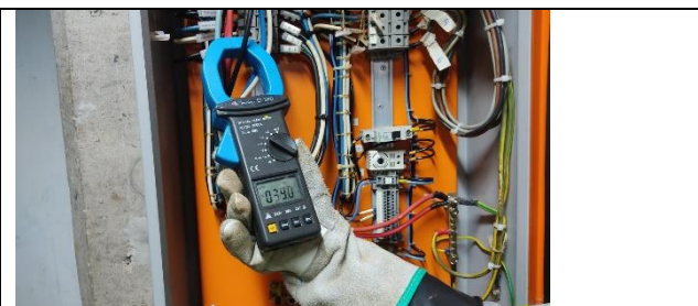
Figura 12: Realizado testes de energia com alicate amperímetro.
