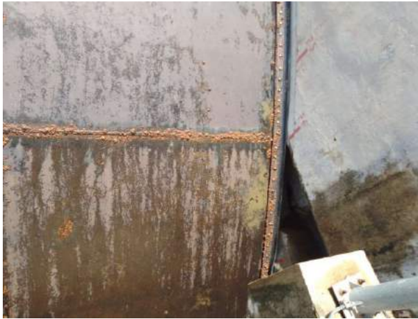
Figura 72 – Inspeção nas talas, vedações laterais e soldas VT - 2
