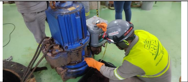
Figura 68: Reposição de óleo na motobomba do poço de drenagem.
