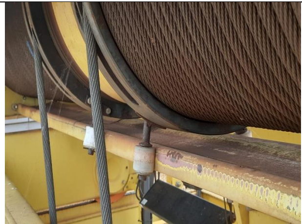
Enrolador de cabo do moitão principal
