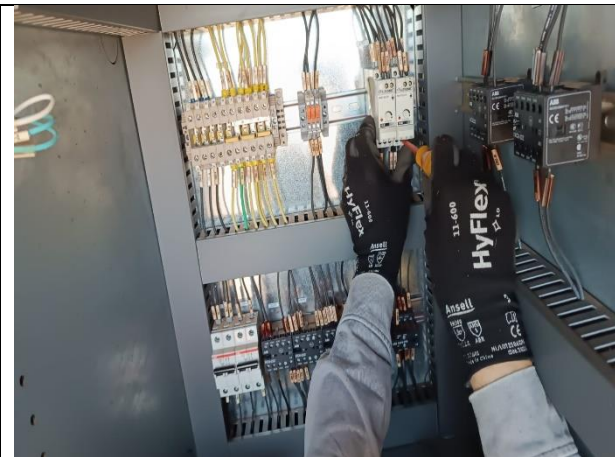
Figura 21 – Inspeção dos componentes e conferência de aperto nos bornes
