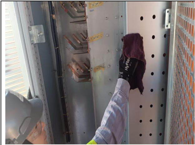
Figura 03 – Limpeza do quadro
