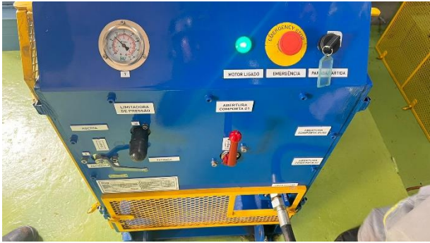
Pressão de trabalho pela motobomba de emergência (130 bar)
