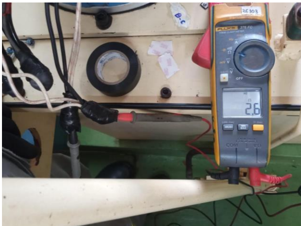
Verificações na resistência de aquecimento do motor 1
