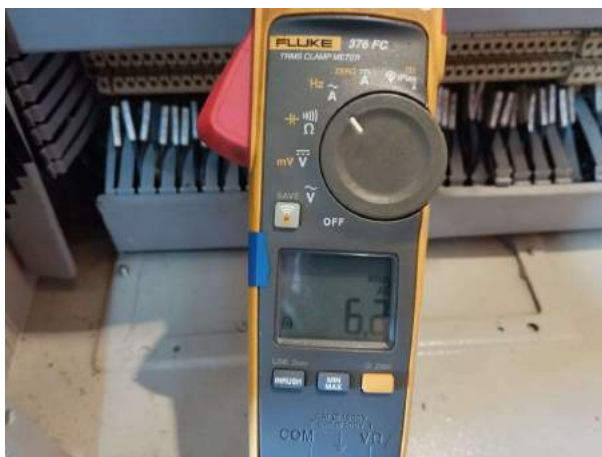
Figura 125 – Verificação das correntes dos motores (sem carga) VT - 3
