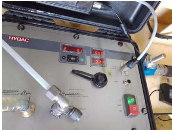
Figura 96 – Filtragem do óleo UHVT-03 (NAS 8, após filtragem)
