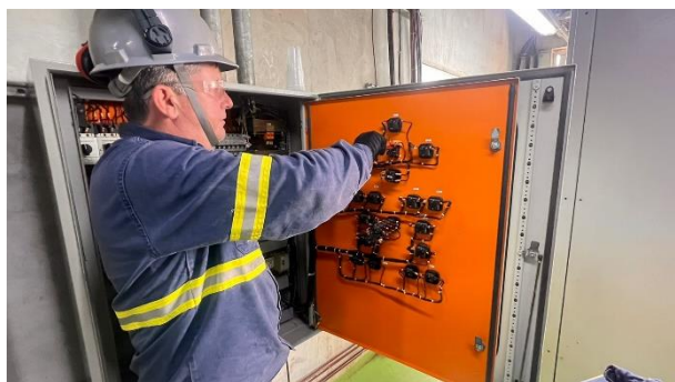
Inspeção e testes nos componentes internos do quadro
