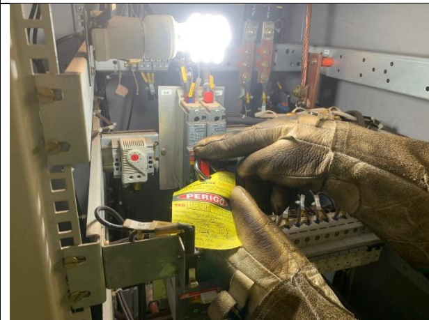
Figura 03 – Secionamento disjuntor DJB painel CB1 retificador 125Vcc
