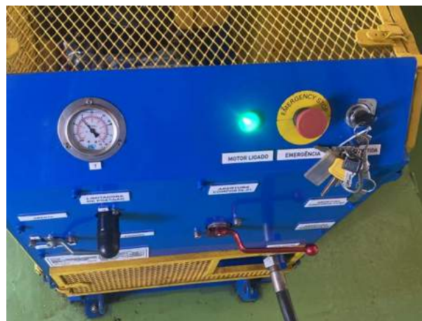
Figura 82 – Abertura VT – 2 pela motobomba de emergência (140 bar)
