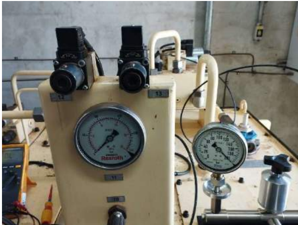
Figura 93 – Teste de atuação de alta pressão UHVT-03
