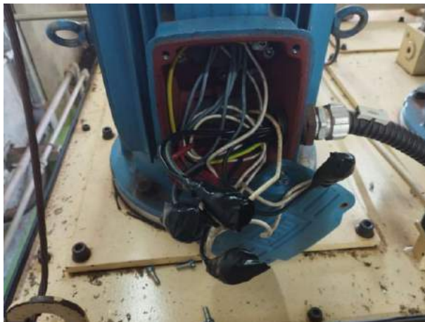
Figura 96 – Verificações na motobomba 01 quanto ao estado e cabeamento
