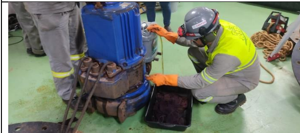
Figura 69: Reposição de óleo na motobomba do poço de drenagem.
