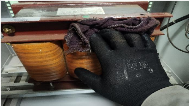
Figura 15: Limpeza geral do painel do Retificador com pano seco.
