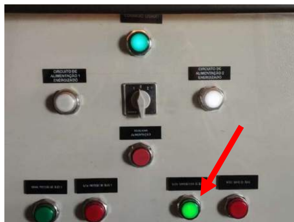
Figura 33 – Atuação do alarme de alta temperatura
