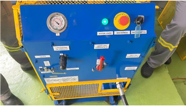
Abertura VT – 1 pela motobomba de emergência
