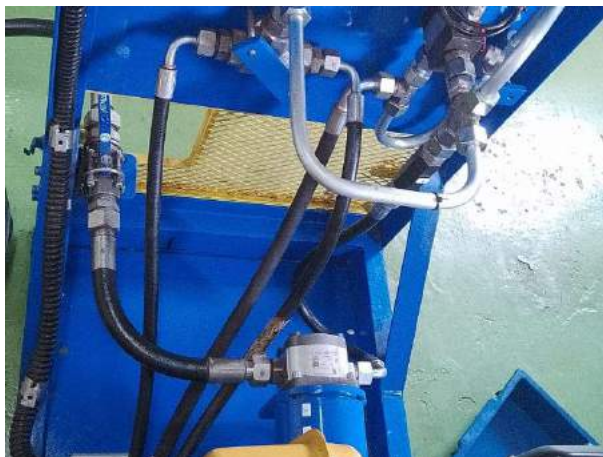
Figura 58 – Inspeção na bomba, conexões e mangueiras hidráulicas da moto-bomba a diesel UHVT-01-02
