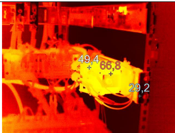
Figura 35 – Quadro Retificador 48Vcc B2
