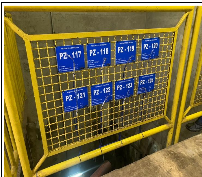
Foto 21 – Galeria acima onde foram direcionados os cabos dos devidos instrumentos.
