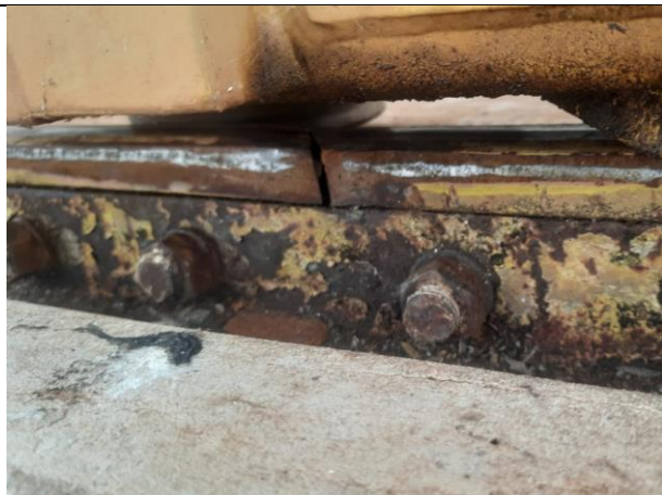
Figura 07 – Emenda dos trilhos, onde ocorre o travamento do Pórtico, aparentemente desalinhada
