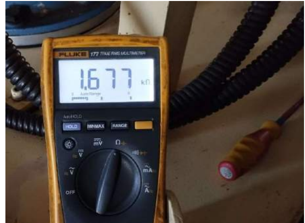
Figura 24 – Verificações na resistência de aquecimento do motor 2
