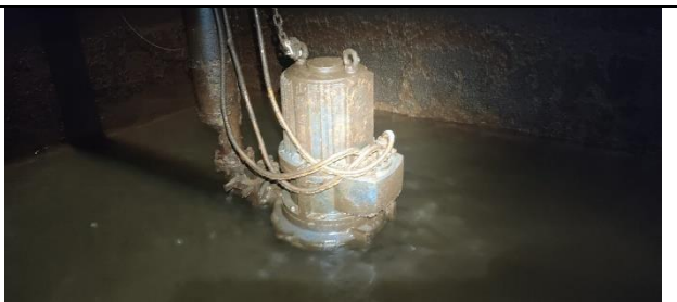
Figura 42: Inspeção realizada no poço, verificando estado de conservação das bombas no geral.
