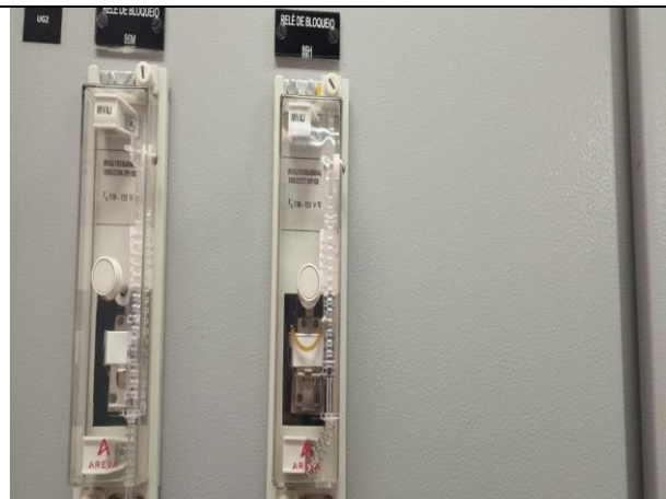
Figura 10 – Identificado ponto quebrado onde se faz o reset da proteção 86.
