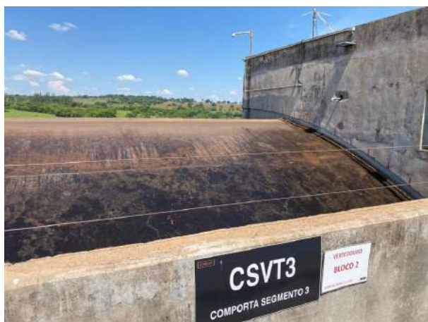
Figura 84 – Manobra de acionamento completa da comporta 03
