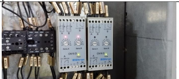
Figura 36: Realização de teste de atuação no sensor de nível.
