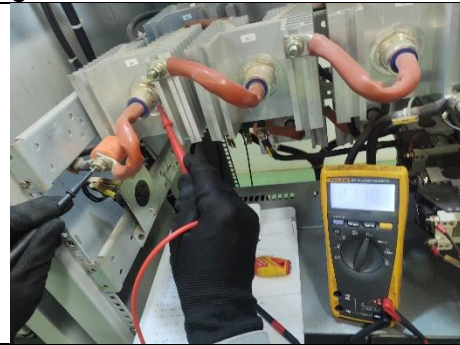
Figura 12: Realização de medições de grandezas elétricas.
