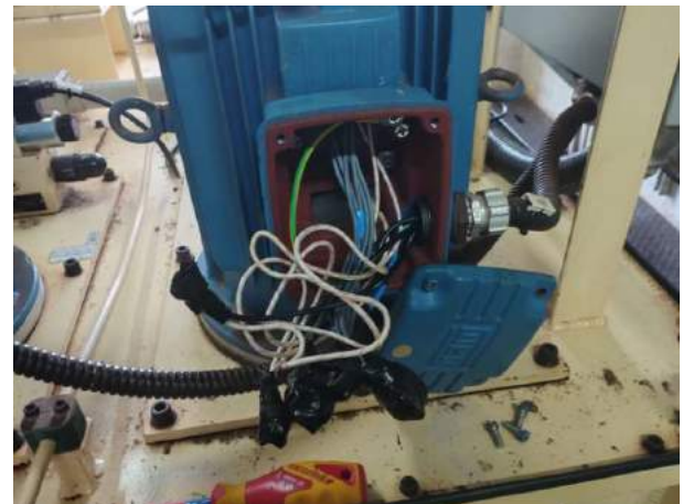
Figura 97 – Verificações na motobomba 02 quanto ao estado e cabeamento
