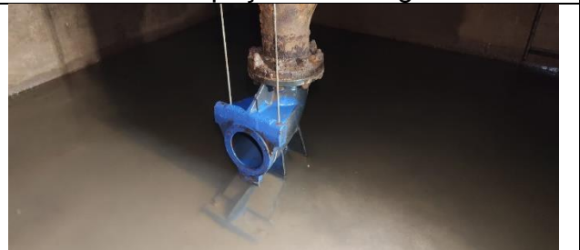
Figura 70: Tubulação de conexão da motobomba.
