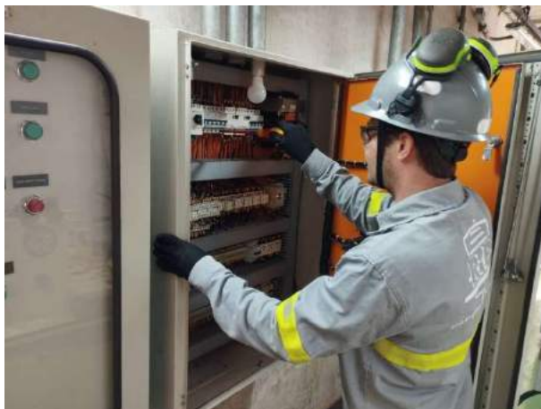
Figura 43 – Inspeção e testes nos componentes internos do quadro
