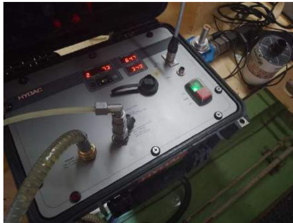
Figura 18 – Filtragem do óleo UHVT-01-02 (NAS 7, após filtragem)
