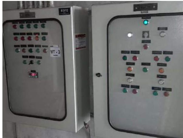
Figura 119 – Verificações de TAGs nos quadros
