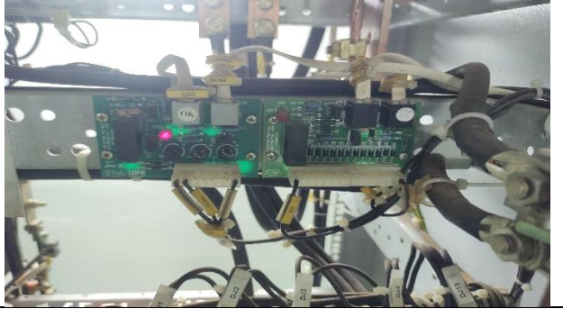
Figura 10: Verificação do estado das placas eletrônicas presentes no Retificador.
