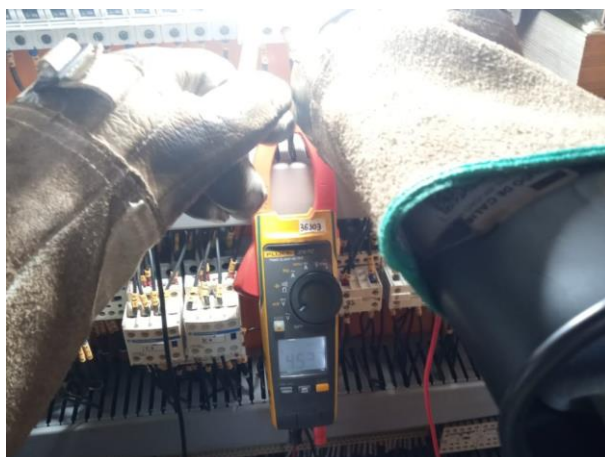
Inspeção e testes nos componentes internos dos quadros VT - 3
