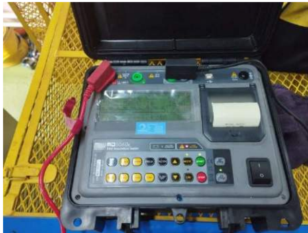
Figura 98 – Medição de resistência de isolamento motores UHVT-03
