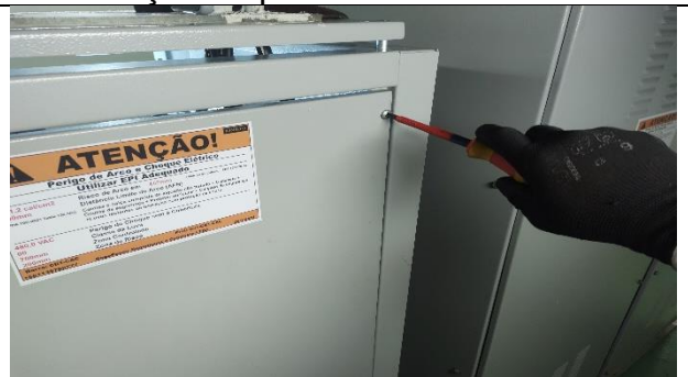
Figura 29: Fechamento da tampa traseira do painel 48Vcc.
