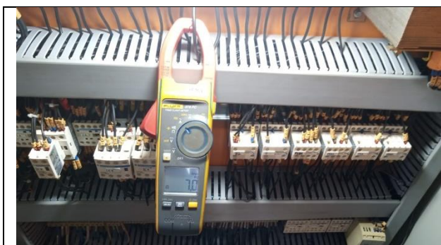
Verificação das correntes dos motores (sem carga) VT - 3
