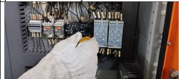
Figura 33: Reaperto de conexões do painel de alimentação das bombas.
