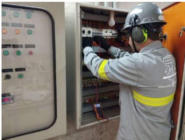
Figura 116 – Inspeção e testes nos componentes internos do quadro
