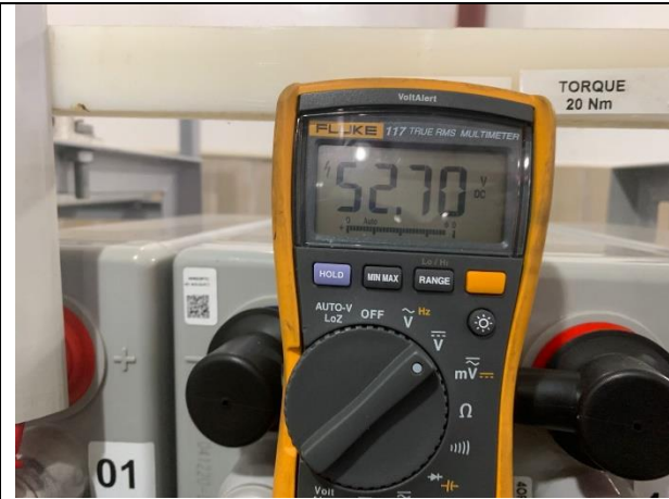
Figura 01 – Medição de tensão flutuação total do banco de baterias.
