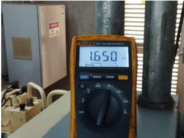
Figura 100 – Verificações na resistência de aquecimento do motor 1
