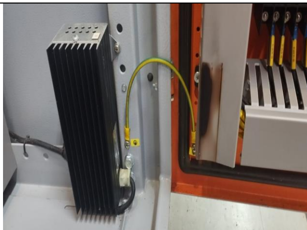
Figura 11 – Identificado ponto de aquecimento na resistência de calefação.
