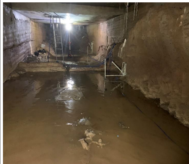
Foto 19 – Vista geral da galeria onde foram instalados todos os instrumentos.
