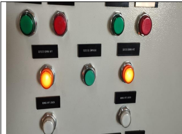
Figura 01 – Atuação de defeito nas bombas 1 e 2 UHVT 1 / 2
