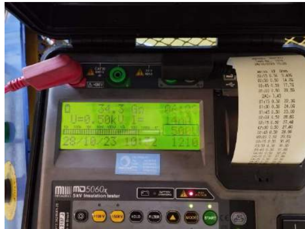
Figura 21 – Medição da resistência de isolamento dos motores e cabos UHVT-01-02
