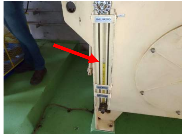
Figura 08 – Nível de óleo UHVT-01-02 após reposição
