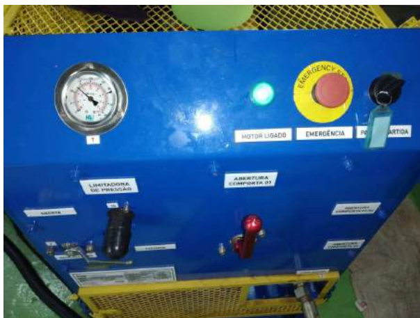
Figura 64 – Abertura VT – 1 pela motobomba de emergência
