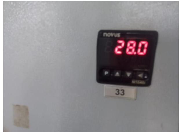
Temperatura real de operação do óleo da central UHVT-03
