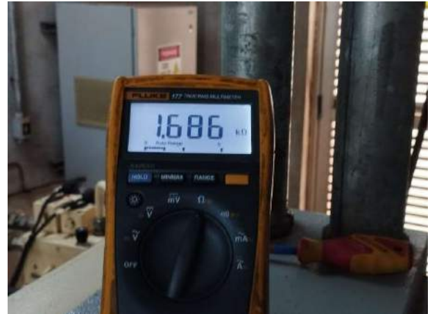
Figura 101 – Verificações na resistência de aquecimento do motor 2
