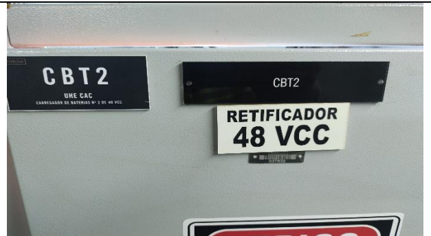
Figura 02: Realização de bloqueio CBT2 48Vcc.
