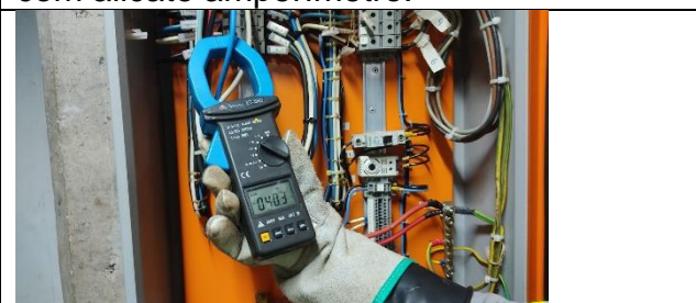
Figura 14: Realizado testes de energia com alicate amperímetro.
