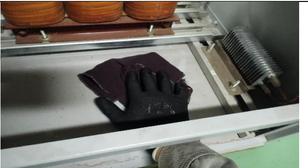
Figura 14: Limpeza geral do painel do Retificador com pano seco.
