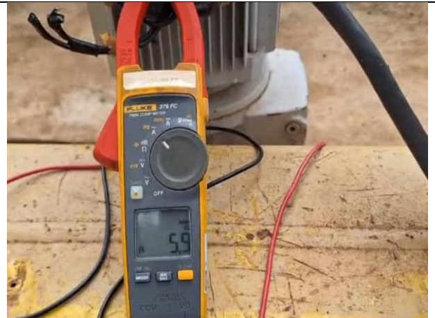
Figura 05 – Corrente do motor na velocidade 2 do Pórtico, em condições normais, variando próximo a 5,9A
