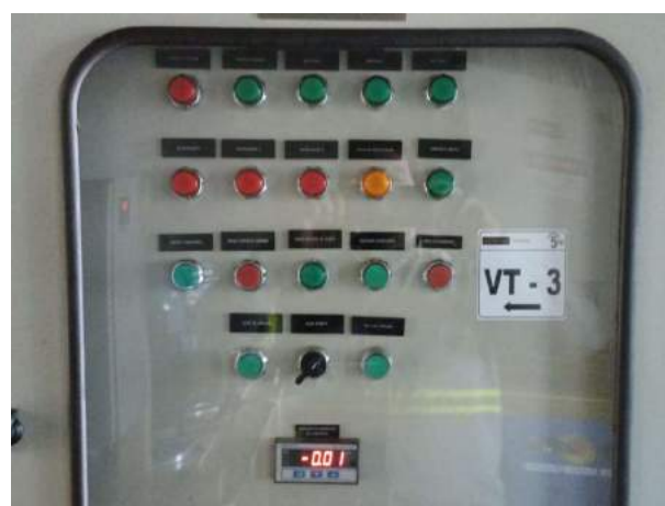
Figura 87 – Falha de sinalização de comporta “FECHADA”
