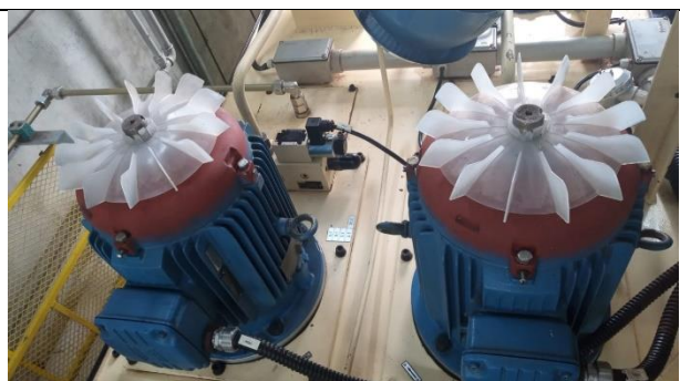
As motobombas apresentam um bom estado de conservação.
