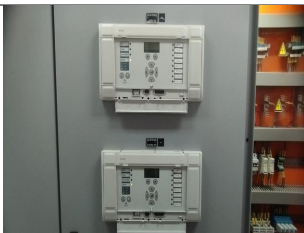
Figura 05 – Inspeção nos relés de proteção.
