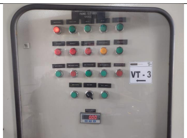
Verificações de TAG's nos quadros
