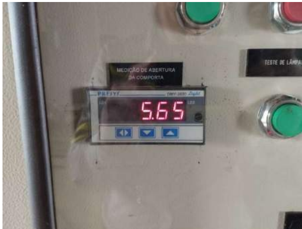
Figura 80 – Posição de abertura VT – 2 painel local
