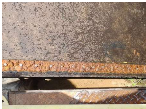
Figura 113 – Talas em processo avançado de oxidação
