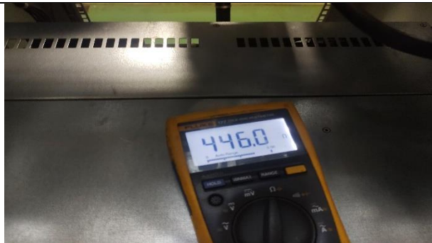
Figura 26: Realizada medição nas bobinas do painel.
