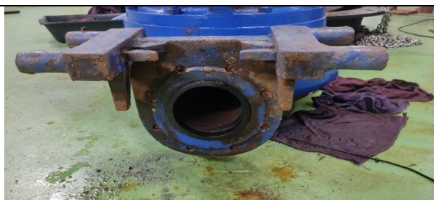
Figura 60: Verificação do estado de conservação da conexão da bomba a tubulação.
