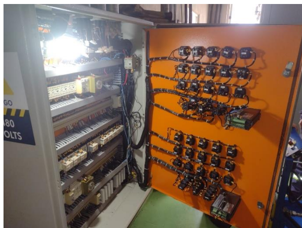
Testes na iluminação interna dos quadros
