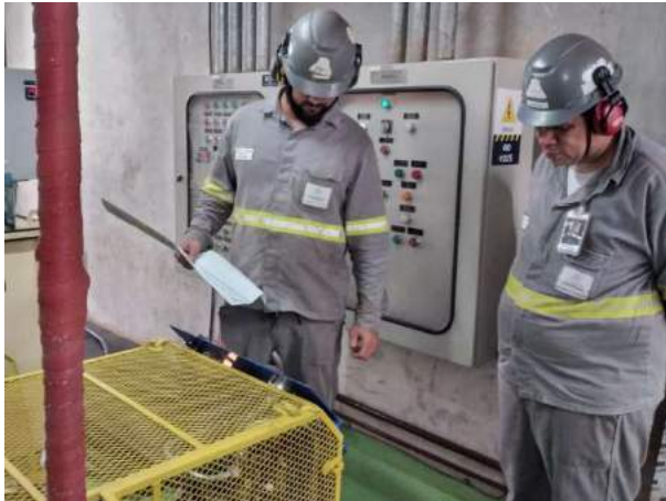
Figura 130 – Testes de abertura pela motobomba de emergência
