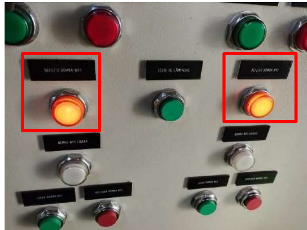
Figura 75 – Testes de atuação dos sinais
