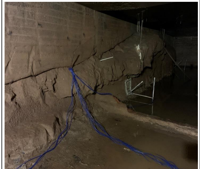
Foto 20 – Cabeamento dos instrumentos foram direcionados à galeria acima, para facilitar a leitura.
