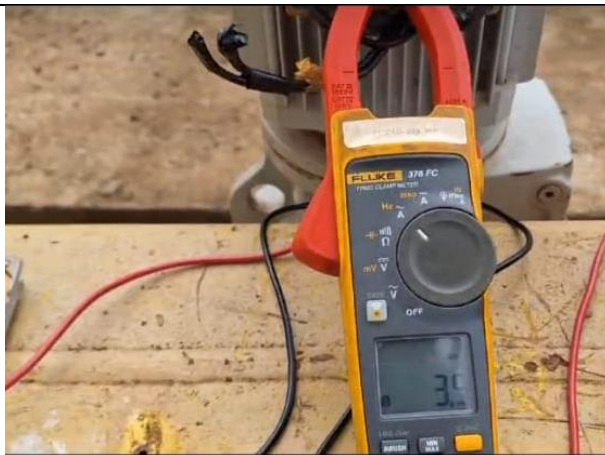
Figura 05 – Corrente do motor na velocidade 1 do Pórtico, em condições normais, variando próximo a 3,5A
