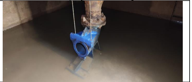
Figura 70: Tubulação de conexão da motobomba.
