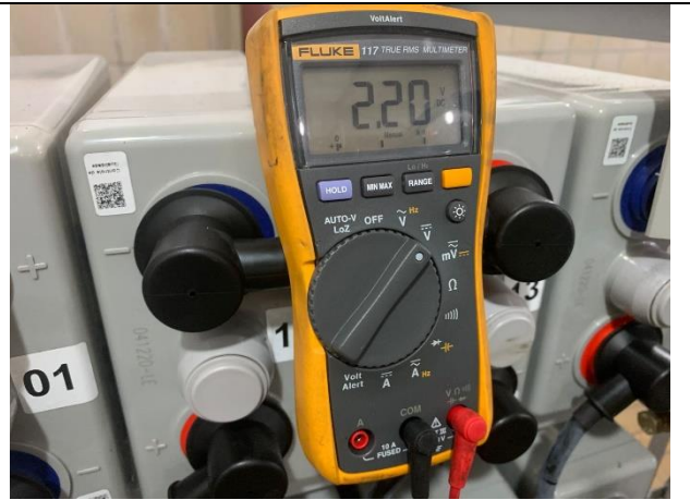
Figura 02 – Medição de tensão VPE flutuação dos elementos do banco de baterias
