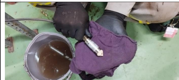
Figura 37: Realização de teste de atuação no sensor de nível.
