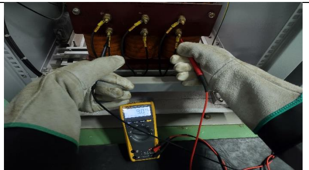
Figura 08: Teste de ausência de Tensão.
