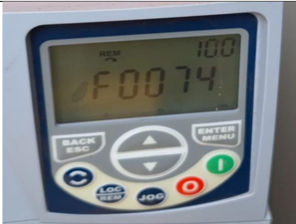
Figura 04 – Atuação de Proteção Falha à Terra no inversor (Falha de sobrecorrente para o terra)
