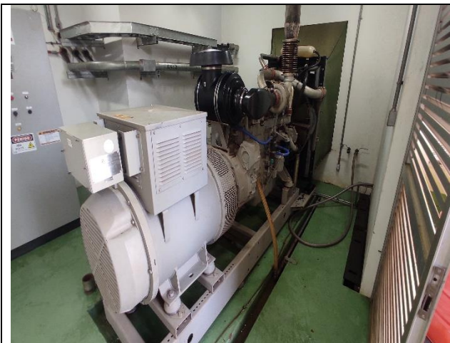
Figura 01 – Grupo Gerador Diesel de Emergência - GDE.
