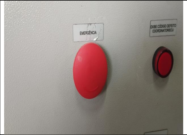
Figura 20 - Necessita substituir Botão de emergência
