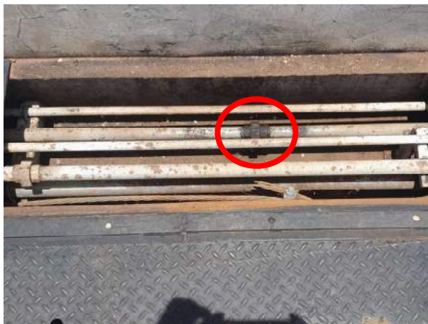
Figura 108 – Indício de vazamentos ocorrido no passado na conexão VT - 3
