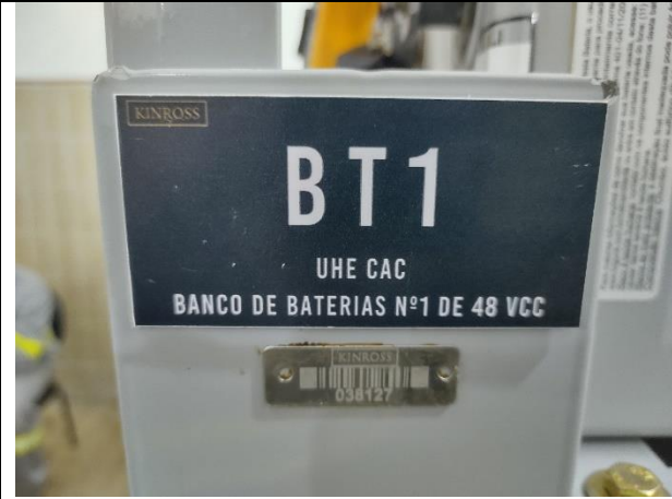
Figura 53 - Placa identificação banco de baterias.
