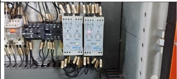
Figura 39: Realização de teste de atuação no sensor de nível.
