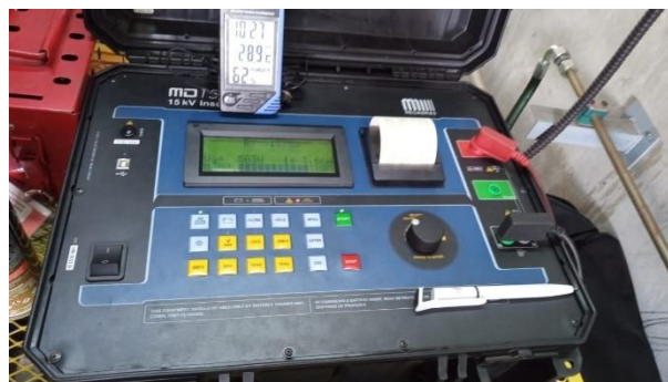
Medição de resistência de isolamento motores UHVT-03
