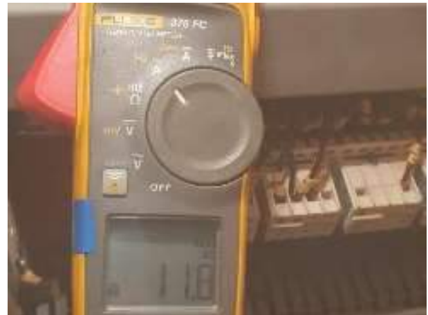
Figura 55 – Medição de corrente do motor B1OL2 com carga
