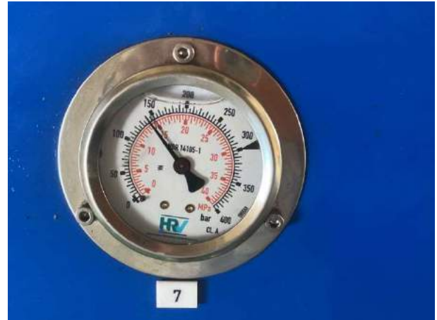
Figura 131 – Pressão de trabalho pela motobomba de emergência (140 bar)
