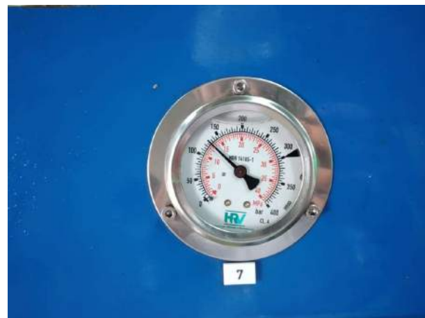
Figura 65 – Pressão de trabalho pela motobomba de emergência (130 bar)
