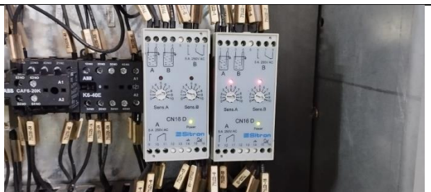
Figura 38: Realização de teste de atuação no sensor de nível.
