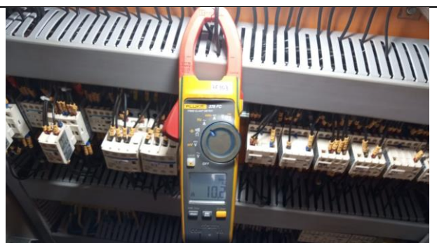
Verificação das correntes dos motores (com carga) VT - 3
