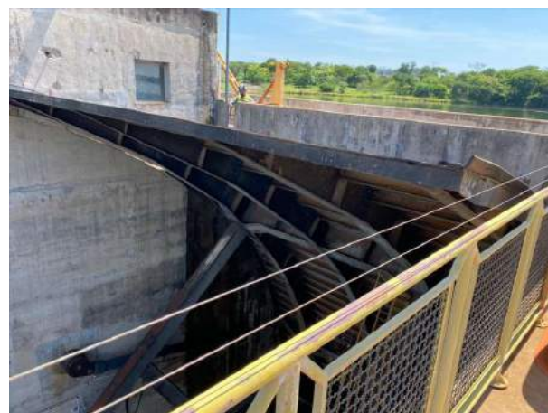
Figura 85 – Manobra de acionamento completa da comporta 03
