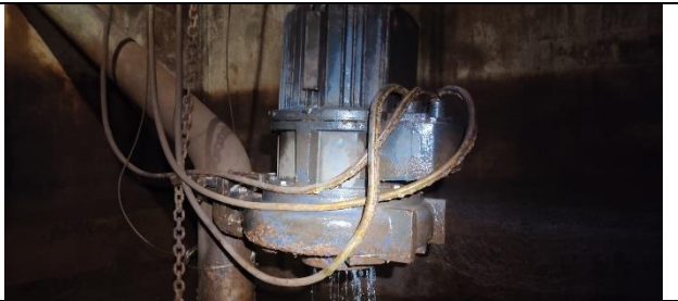
Figura 50: Inspeção realizada no poço, verificando estado de conservação das bombas no geral.
