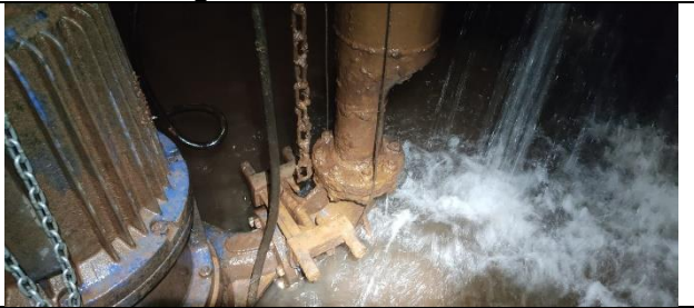
Figura 44: Inspeção realizada no poço, verificando estado de conservação das bombas no geral.
