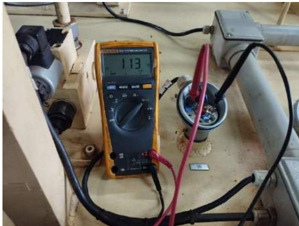
Figura 28 – Medição do RTD do PT-100 central UHVT-01-02
