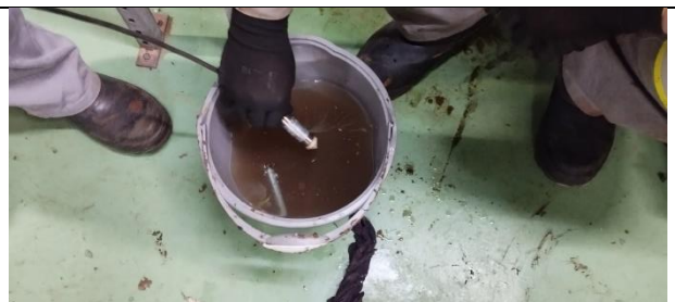
Figura 40: Realização de teste de atuação no sensor de nível.
