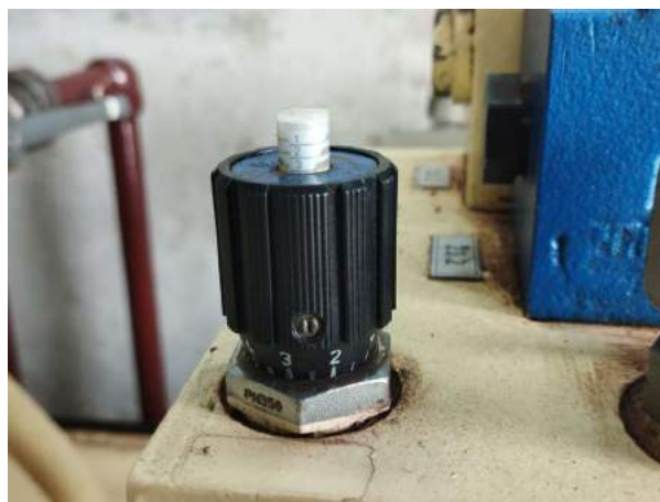
Figura 78 – Válvula reguladora de fluxo (24.2) 100% aberta UHVT-01-02
