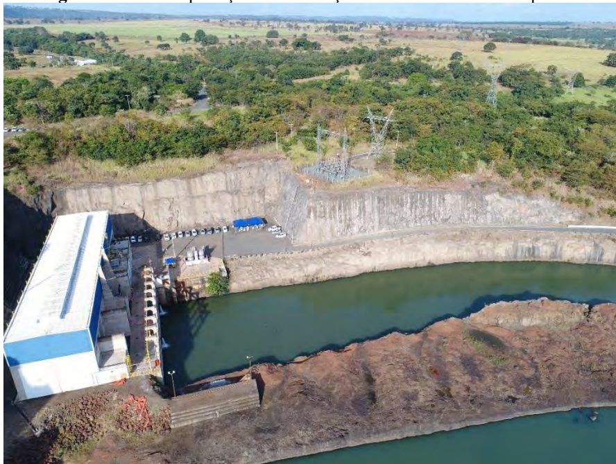
Figura 3: Cerca de proteção na subestação da UHE Barra dos Coqueiros.
